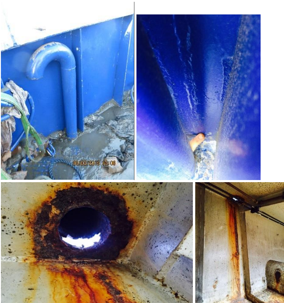
Figur 4: Bildene viser korrosjon i festet av en svanehals. Hullet lå plant med dekket og var skjult på baksiden av svanehalsrøret inn mot skanseledningen. På bildet nederst til høyre kan man også se litt av den gjennomgående kanalen for sidepropellen. Foto: SHT
