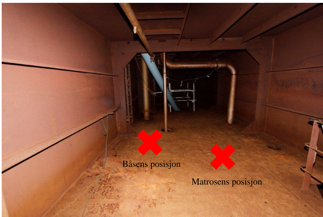
Figur 6: Bilde fra «lower dome». Det usikrede hullet sees bakerst i bildet. Sperringen var ikke på plass på ulykkestidspunktet. Bildet viser også ventilasjonsslangen som var ført ned i tanken gjennom det åpne usikrede hullet. Båsen og matrosens omtrentlige arbeidsposisjon er markert med røde kryss. Foto: Politiet i Asker og Bærum
