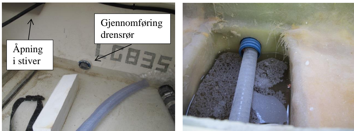
Figur 18: Bildet til venstre viser den utette gjennomføringen av drensørret fra styrehuset sett aktenfra, dvs. fra rommet under flushluken. Øverst i venstre hjørne vises en del av en større åpning i stiveren hvor vann uhindret kunne strømme aktenfra og forover under dørken. Bildet til høyre viser gjennomføringen av drensørret fra styrehuset sett forfra, dvs. fra rommet under styrehuset. Foto: SHT
