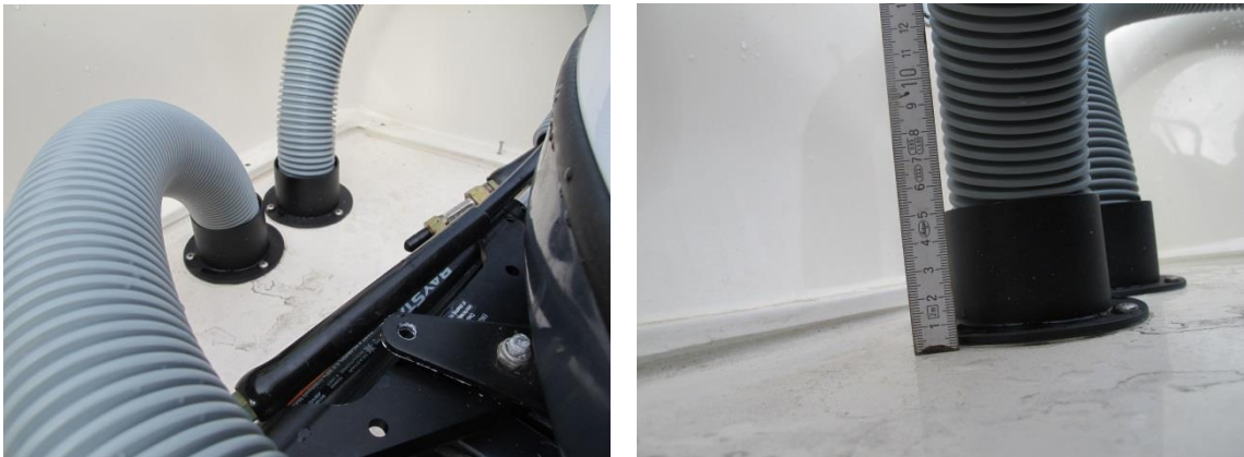
Figur 11: Arrangement for gjennomføring av kabler og drivstoffrør til motor. Foto: SHT
