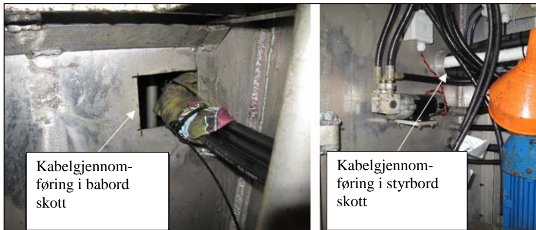
Figur 26: Åpninger for gjennomføring av kabler medførte at tverrskipsskottene i henholdsvis babord skrog (til venstre) og styrbord skrog (til høyre) ikke var vannrette. Foto: SHT
