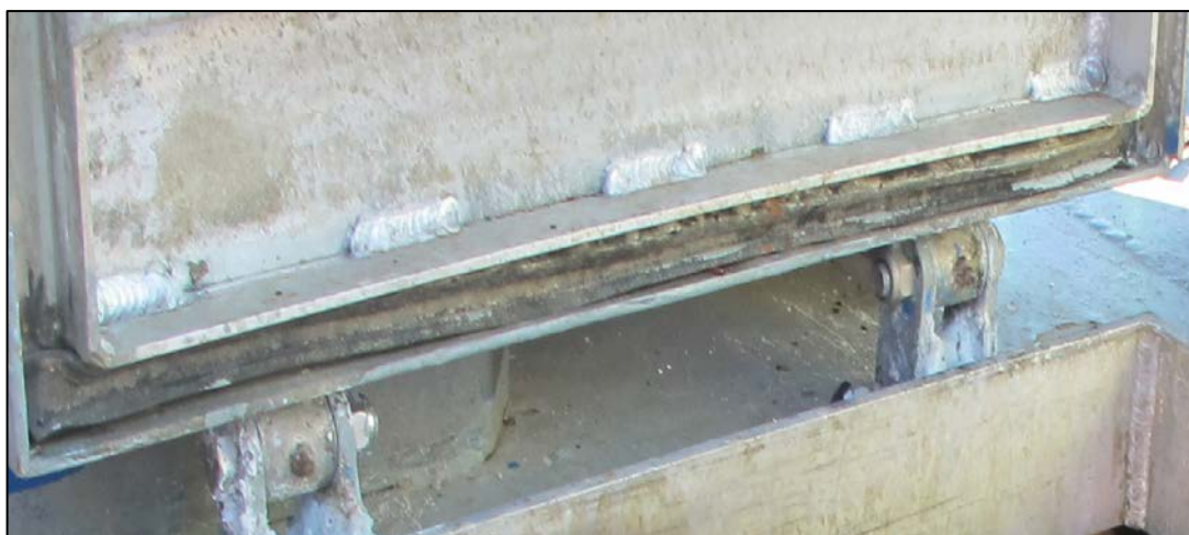
Figur 22: Hengslesiden av aktre babord luke med pakning. Resten av lukedeckslet manglet pakning. Foto: SHT
