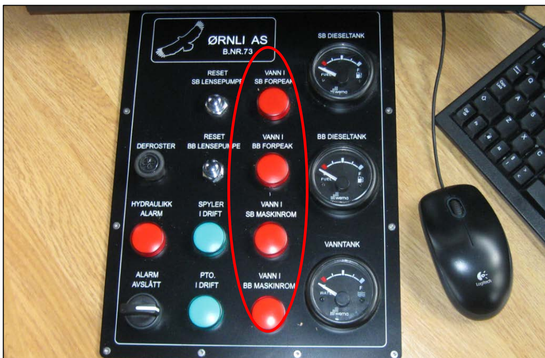
Figur 8: Indikator-/alarmpanelet for lensepumpene var plassert rett under kartplotterskjermen foran og litt til styrbord for manøverposisjonen. Kilde: Ørnli Slipp AS/SHT
