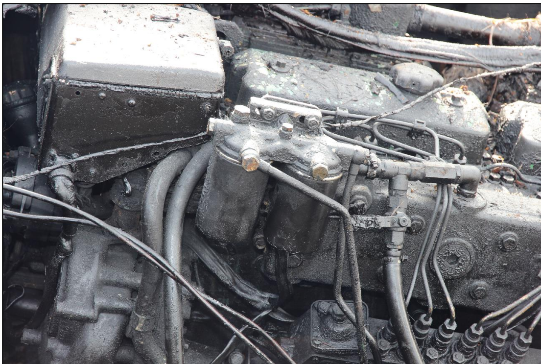
Figur 6: Intakt filterholder/brakett med to dieselfiltre på styrbord motor. Foto: Politiet
