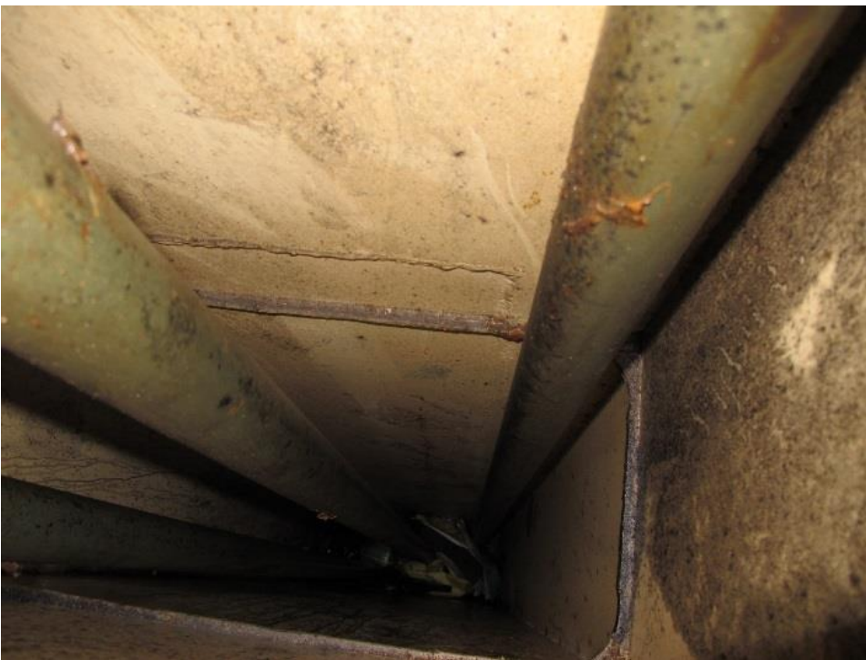
Figur 18: De tre pitch-stagene ført vertikalt gjennom trunken til maskinrommet. Foto: SHT
