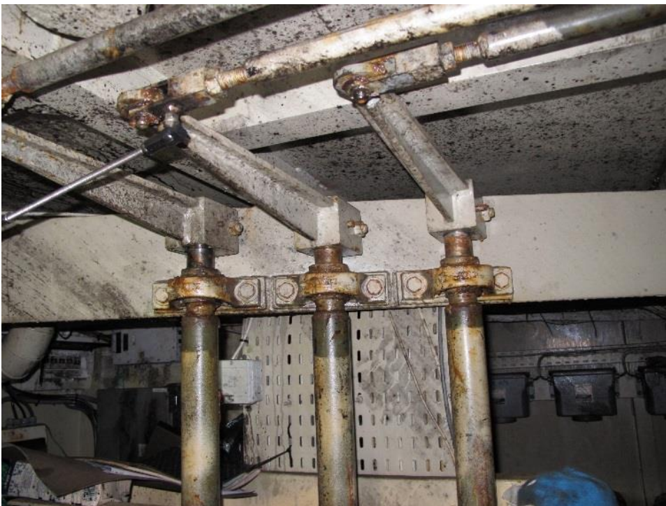
Figur 16: Overføring av langskips bevegelser i de tre horisontale stagene til rotasjon i vertikale stag. Rudder pitch i midten. Foto: SHT
