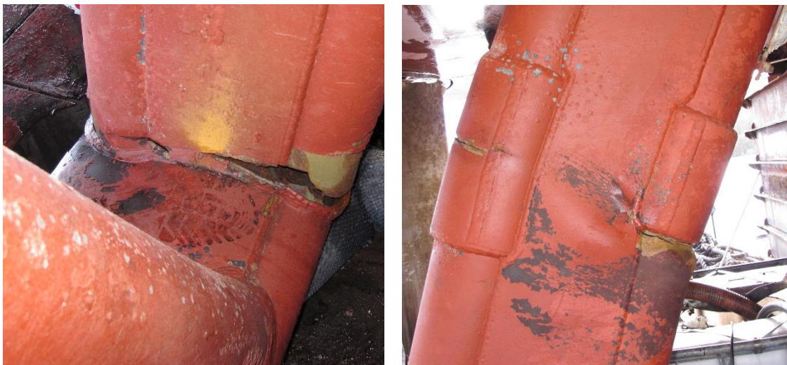
Figur 21: Aktre senterstag avrevet ved fot, sprekker/bøyd på "halv" høyde. Foto: SHT
