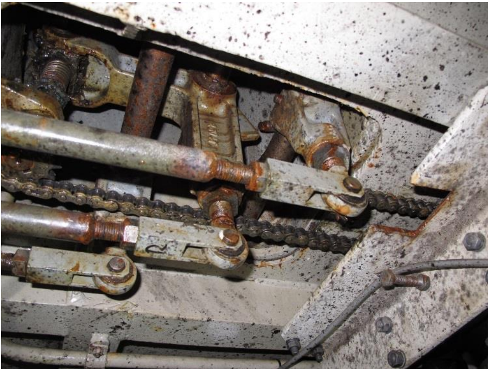
Figur 14: Inne i styrehusets manøverkonsoll (forkant). Vertikal gjengestang fra rattet på manøverkonsollen øverst til venstre. Tre horisontale stag går akterover (mot venstre), nærmest i bildet er stag for styrbord driving pitch, i midten for rudder pitch og lengst vekk for babord driving pitch. Foto: SHT
