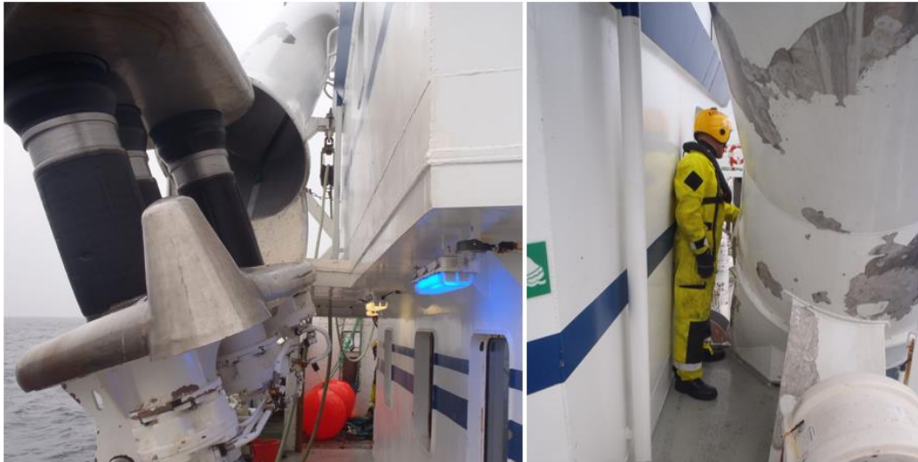
Figur 5: Bildene viser området mellom notrøret og styrhusskottet. Bildet til venstre er tatt fra hoveddekk forfra. Bildet til høyre er tatt fra båtdekket aktenfra. Foto: Kystvakten
