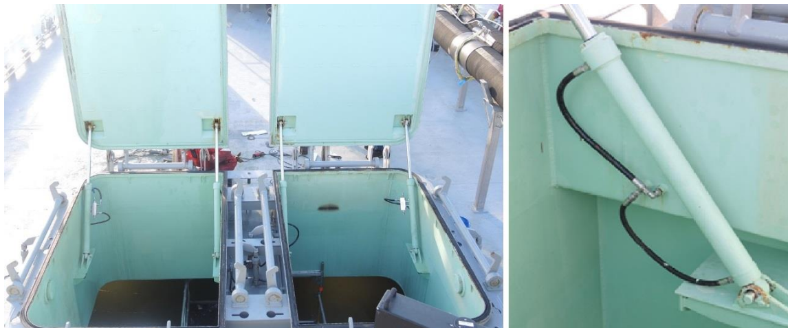
Figur 6: Venstre: brønnlukene. Høyre: en av hydraulikksylindrene. Foto: SHT
