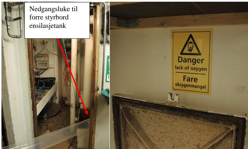
Figur 4: Nedgangslukene til de to forre ensilasjetankene var plassert forut for fabrikk, inne i et trangt rom i fartøyets innredning. Over lukene var det merket «Fare oksygenmangel». Foto: SHT
