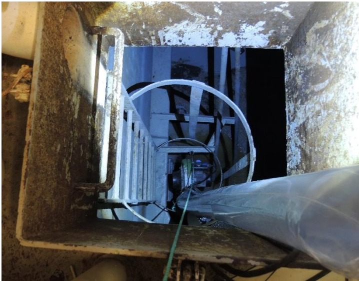
Figur 6: Ryggbøylen til ensilasjetankens leider var til hinder for løfteoperasjonen. Foto: SHT
