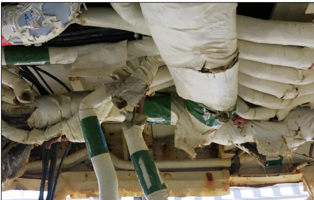
Figur 22: Skade på sjøvannslinjen aktenfor brannsonen 4. Foto: SHK
