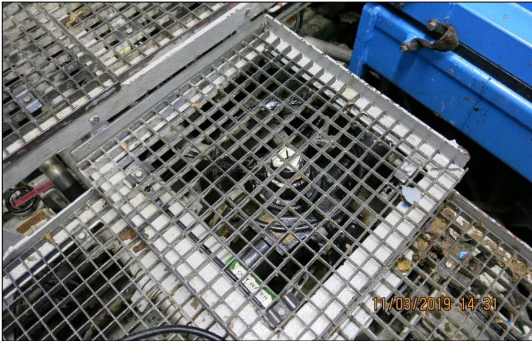
Figur 57: Sugeventil (tag BD-MV056) i sort lokalisert fastmontert under dørkrist i aktre generatorrom. Foto: SHK
