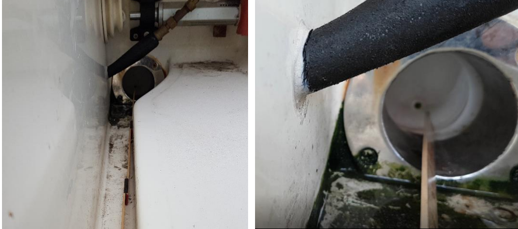
Figur 11: Styrbord lenseport frå innsida. Lysinnsig bak nedre del av svalken fordi han heng med ca. 20 mm glipe til den ytre enden av rørgjennomføringa. Foto: SHK
