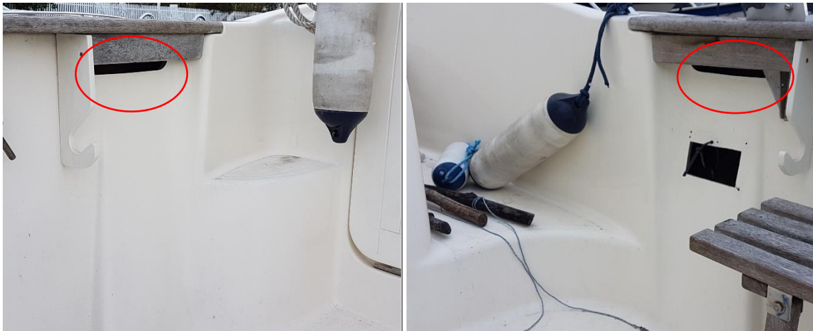
Figur 15: Luftinntak til motorrom babord og styrbord
