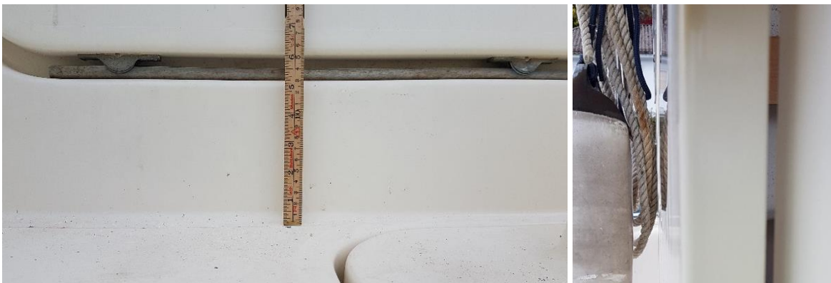
Figur 8: Terskelhøgda på skyvedøra til styrehuset er 160 mm frå den høgaste delen av dekket og 231 mm frå den lågaste delen (botnen i dreneringskanalane). Det er ei glippe mellom dørbladet og skottet. Foto: SHK
