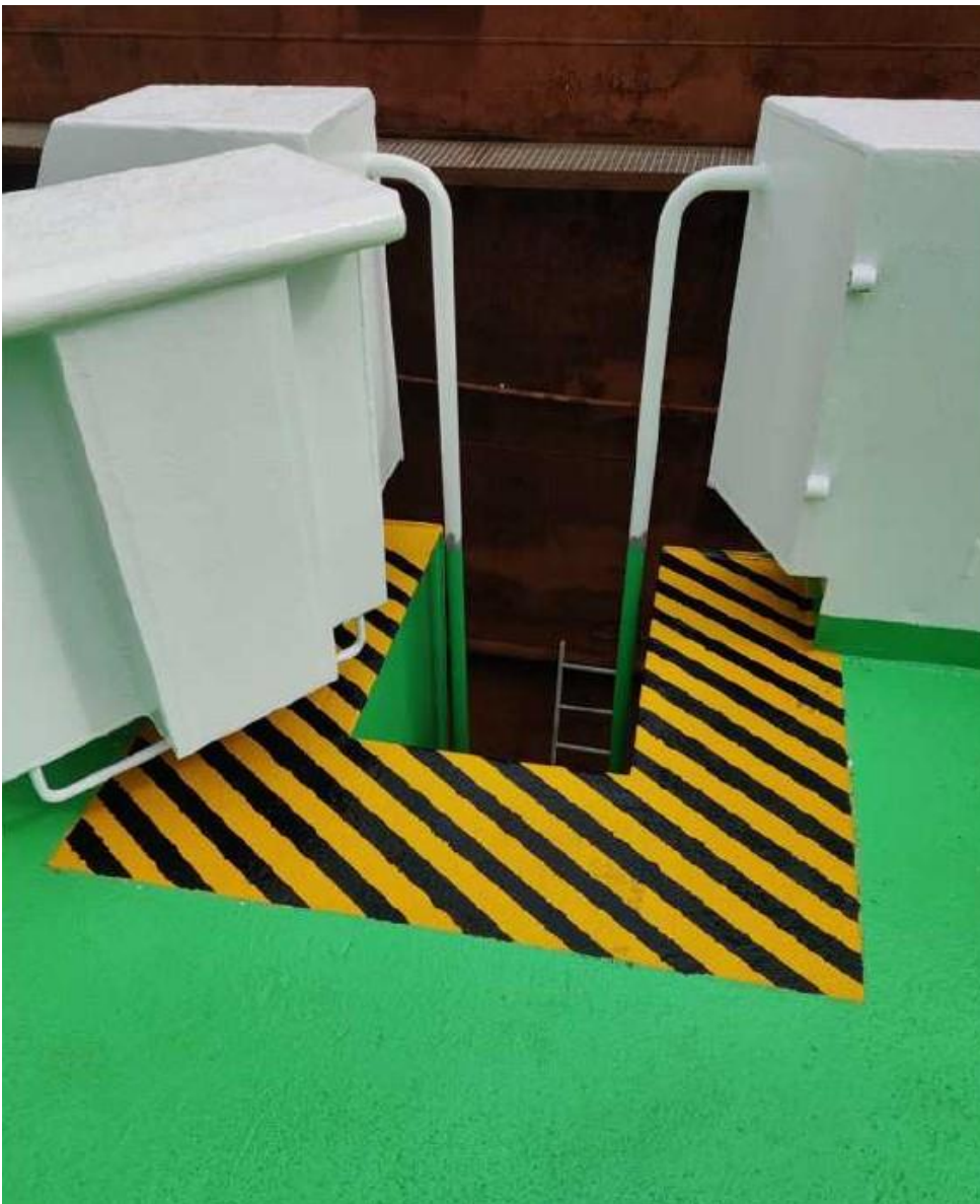
Figur 17: Rekkverk i og oppmerking rundt trappesjakt. Foto: FSV Group
