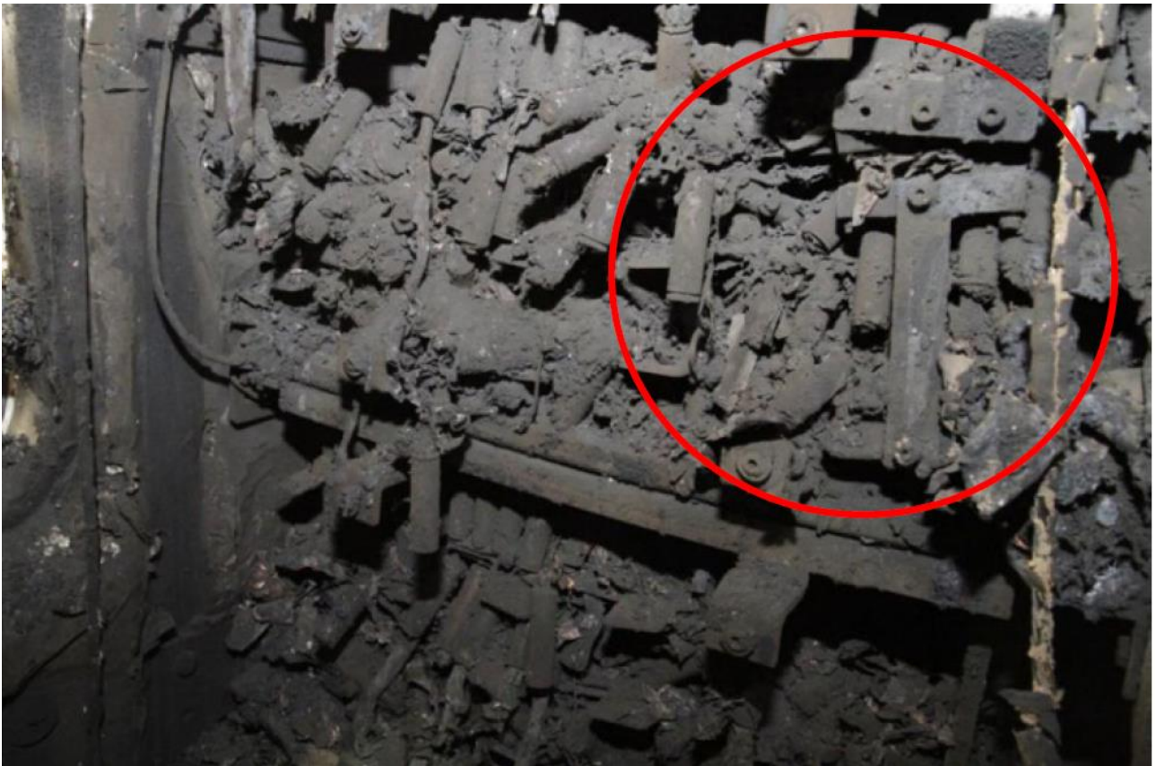
Figur 32: Fra batterirommet, rester av batterimodul 2 i batteristreng 6. Rød ring markerer kobberskinnen. Foto: Kripos
