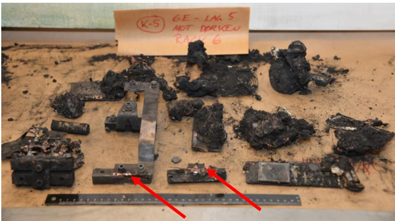
Figur 36: Rester av batterimodul 1 og batterimodul 2 i batteristreng 6, røde piler markerer lysbueskader. Foto: Kripos
