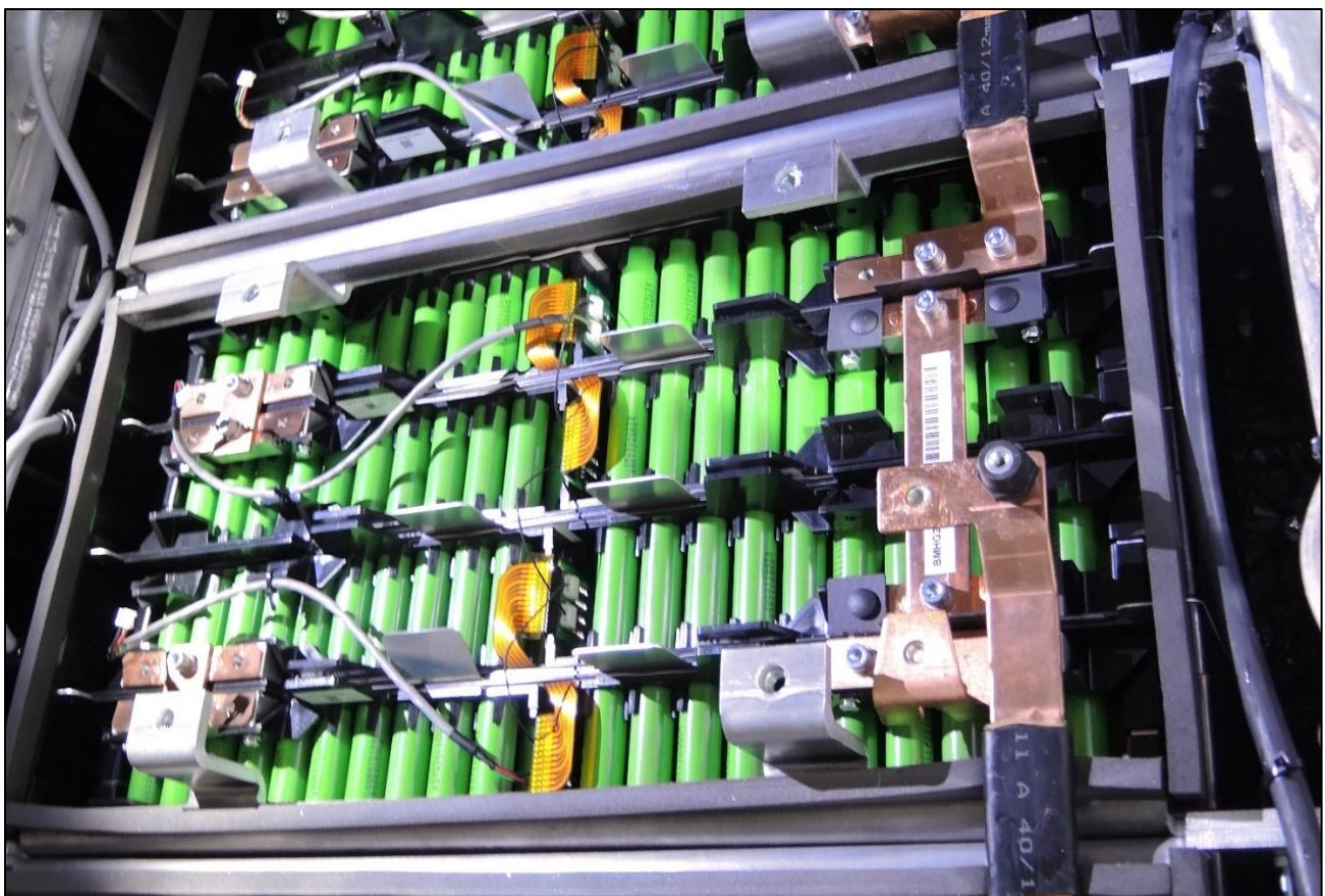
Figur 18: Batterimodul fra babord batterirom med synlige battericeller. Foto: SHK
