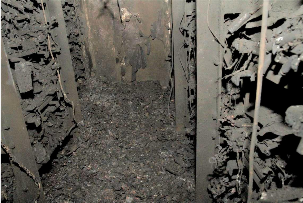
Figur 6: Brannskader i styrbord batterirom. Foto: Kripos
