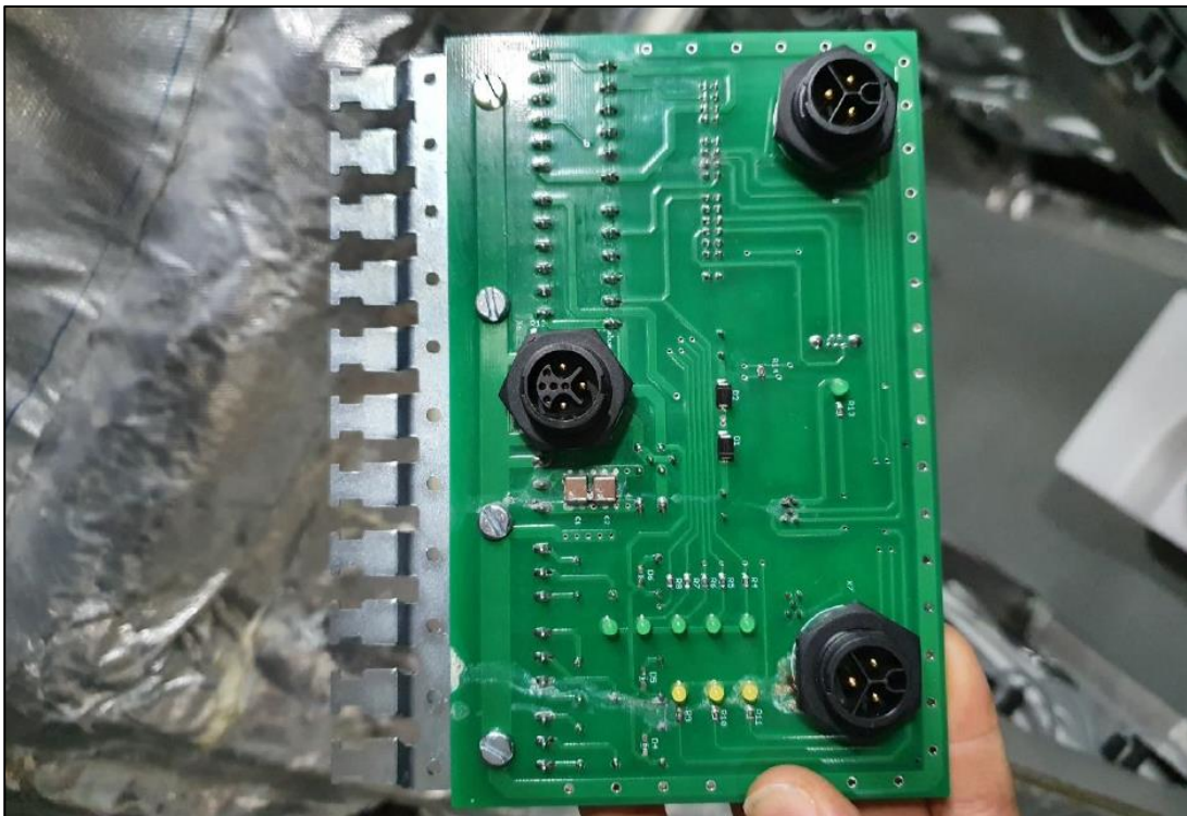
Figur 28: Skadet kretskort på streng 12 som ble byttet ut. Foto: Batterileverandøren
