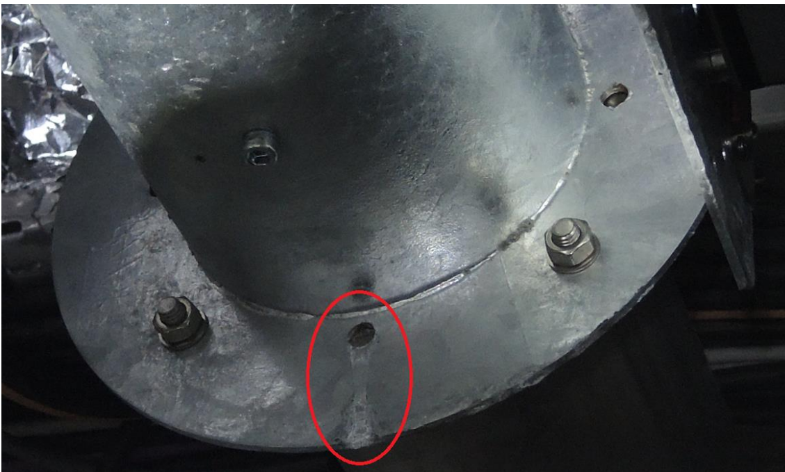
Figur 42: Saltavleiringer nederst på flensen til brannspjeldet på ventilasjonsutløpet. Foto: SHK
