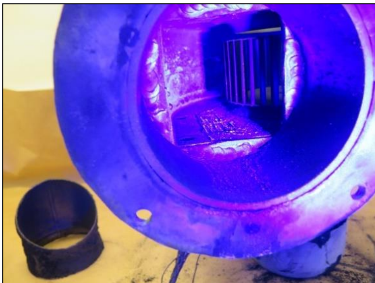
Figur 38: Innsiden av styrbord viftehus. UV-lys ble brukt for å identifisere spor etter sprut og fukt. Foto: SHK
