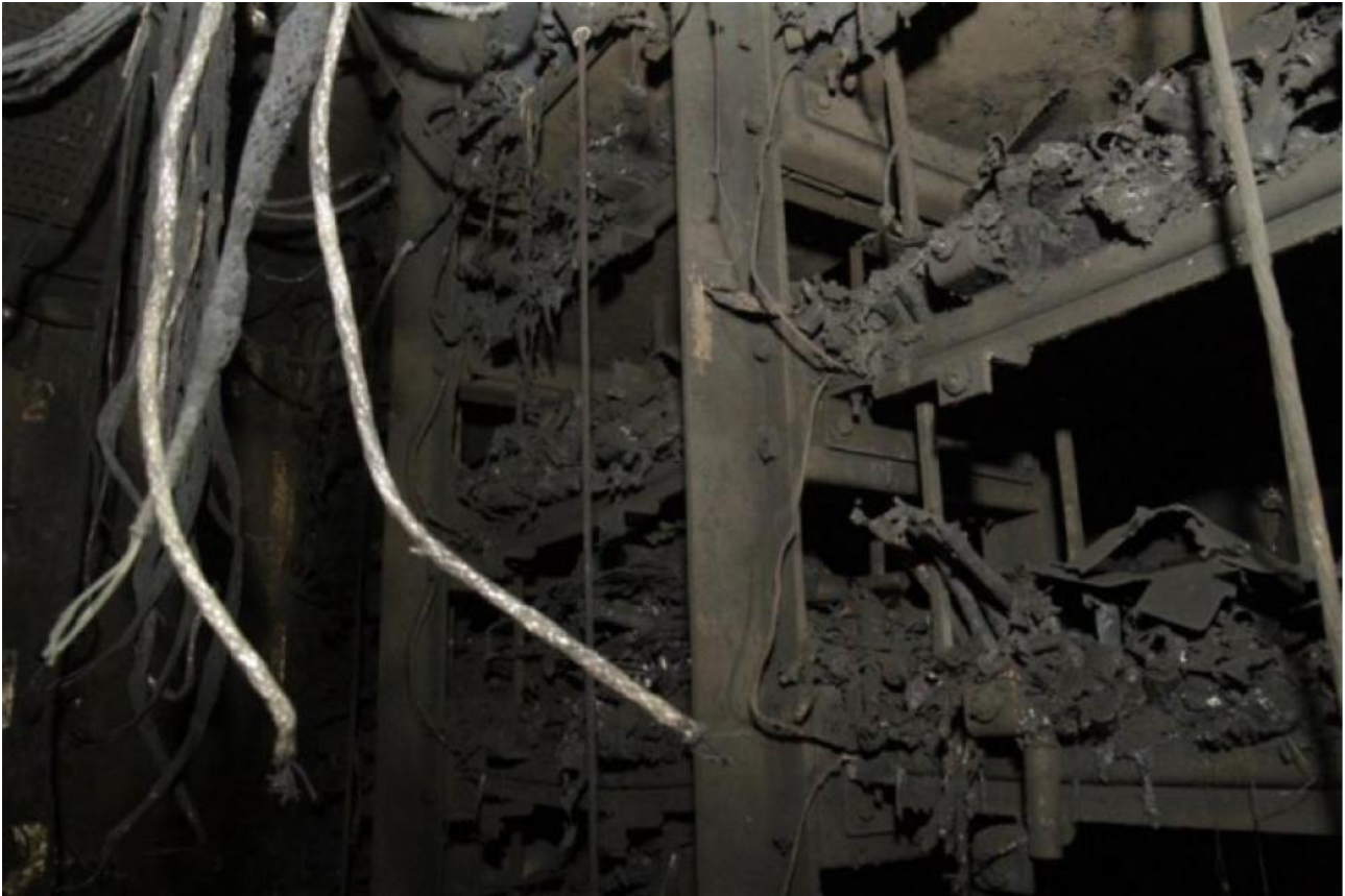
Figur 31: Skadeomfanget i batterirommet sett fra batteriromsdøra. Fra venstre er batteristreng 3 og 2. batteristreng 1 er ved siden av 2, men ses ikke på bilde. Foto: Kripas
