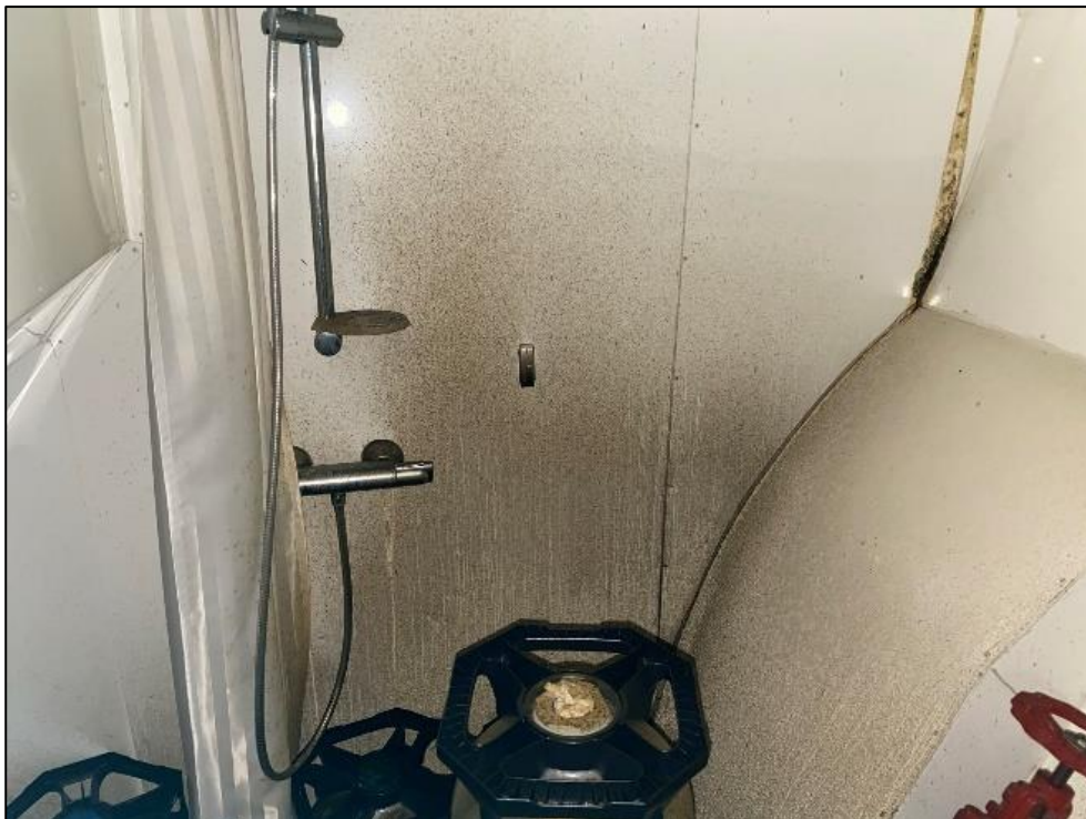
Figur 7: Tydelige spor av høy varme som har skadet tilstøtende vegg mot batterirom. Foto: Forsikringsselskapet
