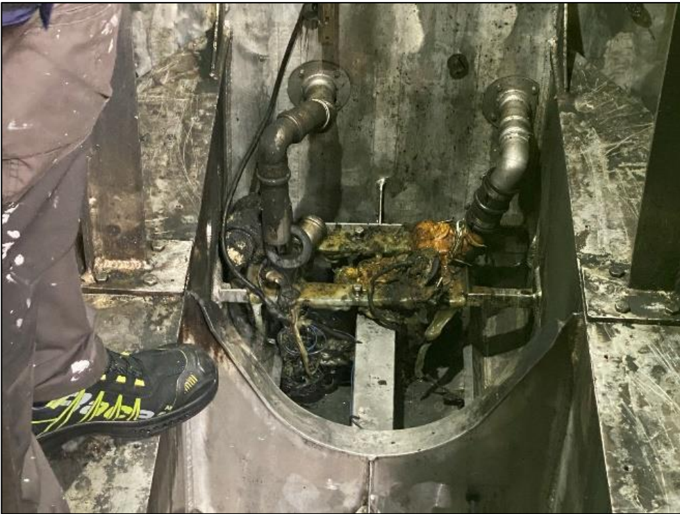
Figur 8: Gråvannstanken var plassert under dørken i batterirommet. Foto: Forsikringselskapet
