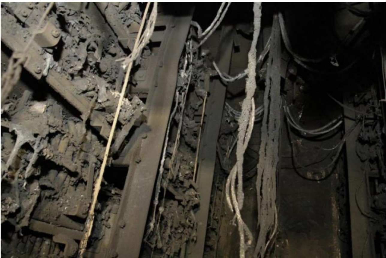
Figur 30: Skadeomfanget i batterirommet sett fra batteriromsdøra. Fra venstre er batteristreng 6,5 og 4. Foto: Kripos
