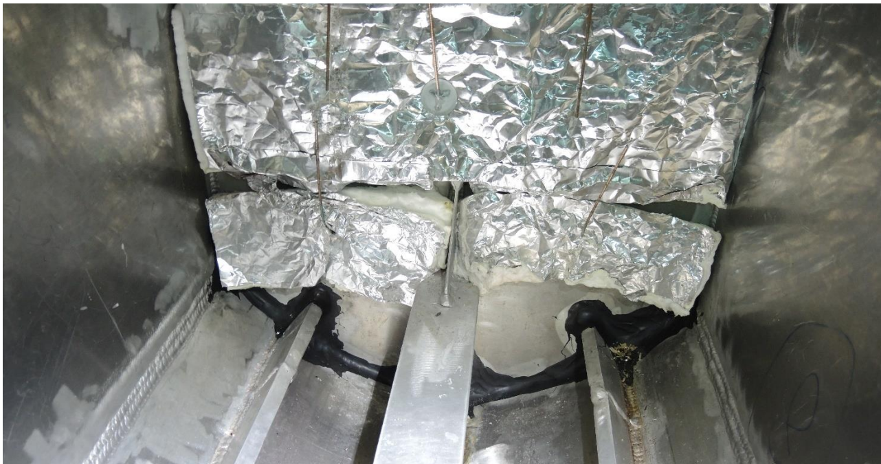
Figur 23: Brannisolasjon nesten ned mot skutebunn, med SIKA Firestop i nedre del. Foto: SHK
