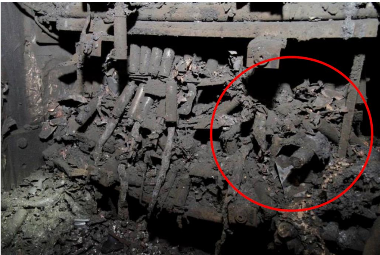
Figur 33: Fra batterirommet, rester av batterimodul 1 i batteristreng 6. Rød ring markerer hvor kobberskinnen skulle ha vært. Foto: Kripos
