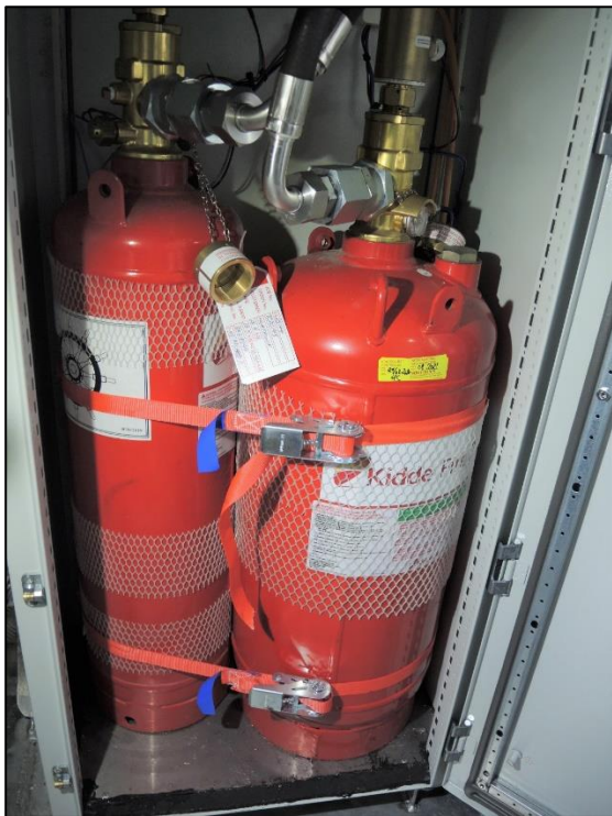
Figur 26: Novec flaskene i babord teknisk rom. Den minste flasken til venstre er til batterirommet og flasken til høyre er til maskinrommet. Begge flaskene ble utløst. Foto: SHK
