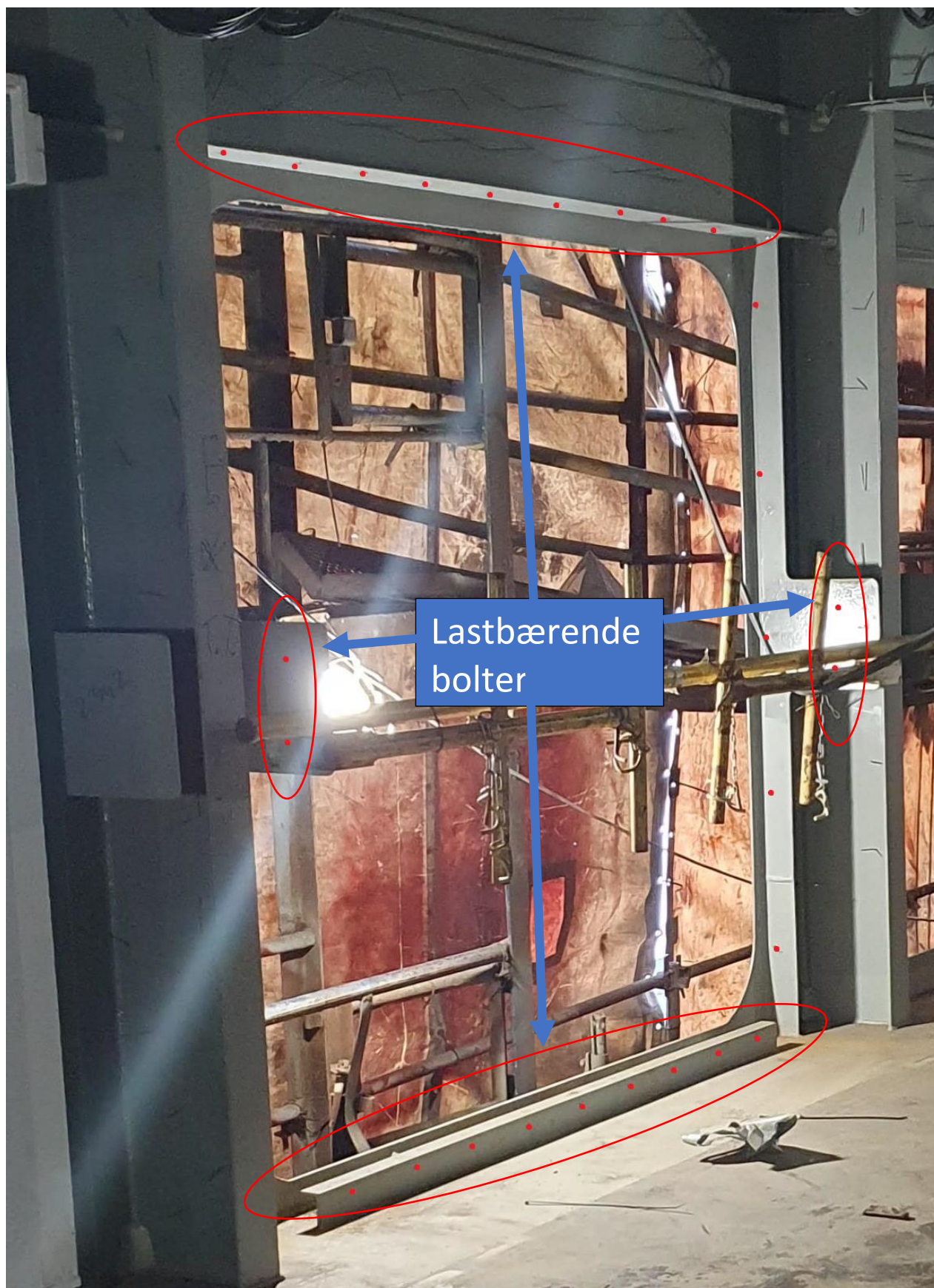
Figur 9-3 Skruerinnfesting, røde prikker viser hvor skruene sitter. De lastbærende skruene er fremhevet.
