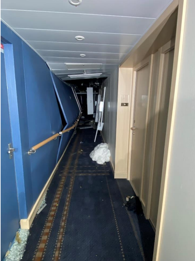
Figur 36: Skader i korridor, sett fra lugar 2010 og 2012 på dekk 2 og akterover. Foto: SHK
