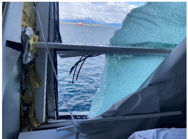
Figur 22: Skader på vindu og karm i lugar 2010. Foto: SHK
