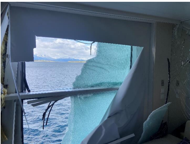
Figur 21: Skader på vindu og karm i lugar 2010. Foto: SHK
