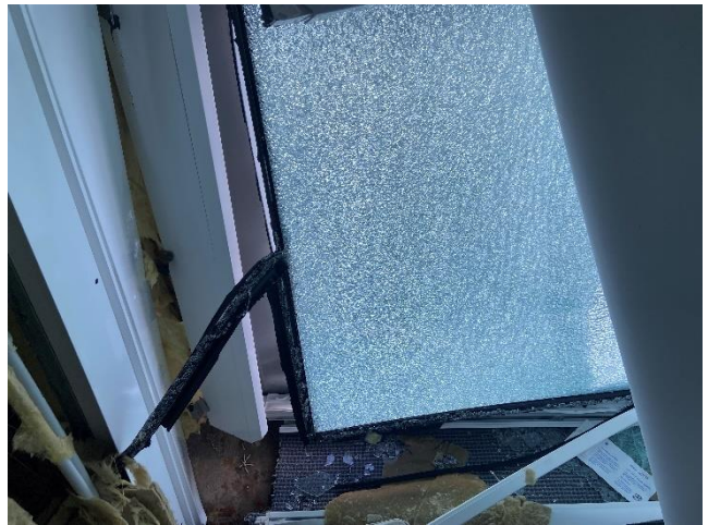
Figur 20: Skader på vindu og karm i lugar 2008. Foto: SHK
