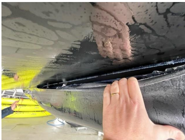
Figur 69: Limslipp ved futurapontong for Zodiac #12. Foto: Driftsselskapet
