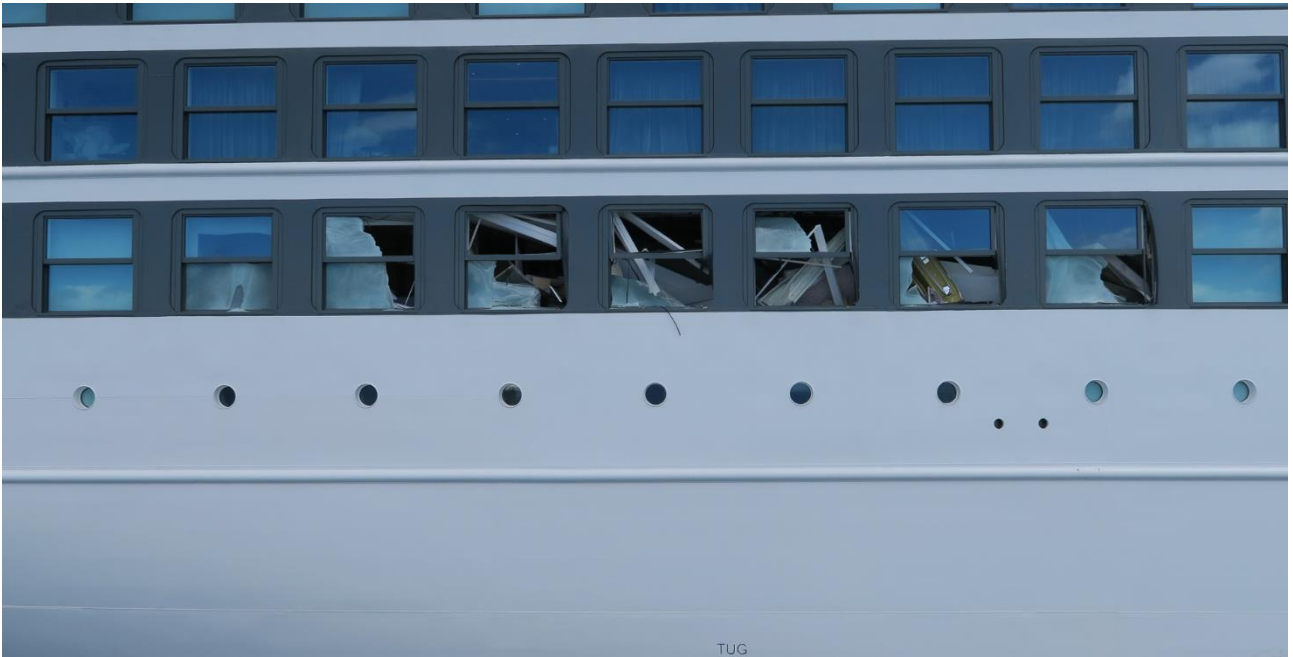
Figur 18: Skader på karmen og vinduer i skadeområdet på dekk 2. Foto: SHK
