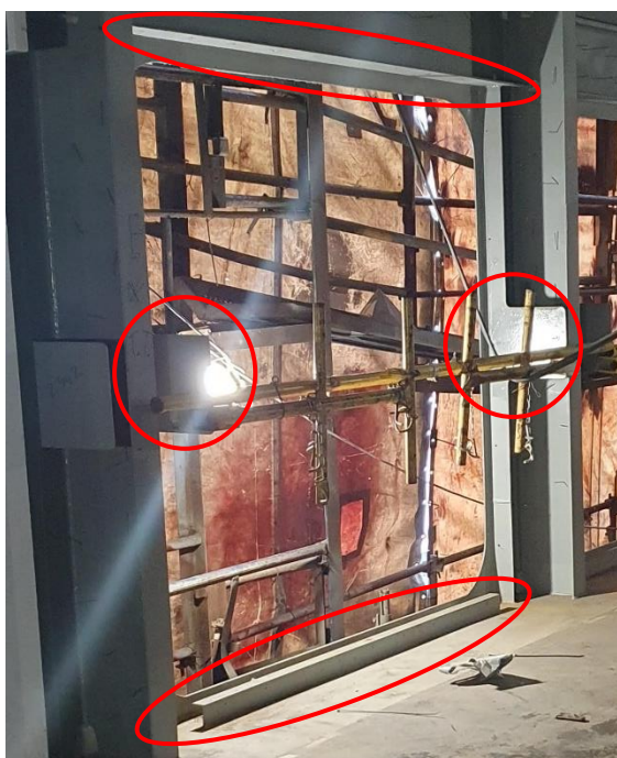
Figur 61: Vindusrammen var festet med bolter oppe og nede. Stiveren var festet til platene på hver side, som angitt av røde ringe. Foto: Verftet/modifisert SHK
