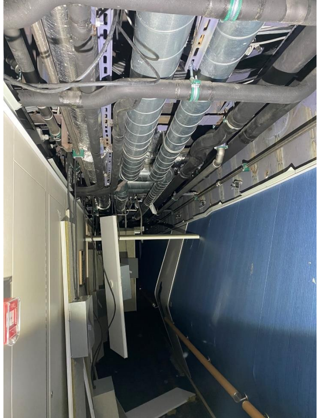
Figur 37: Skader i korridor og himling. Sett forut. Foto: SHK
