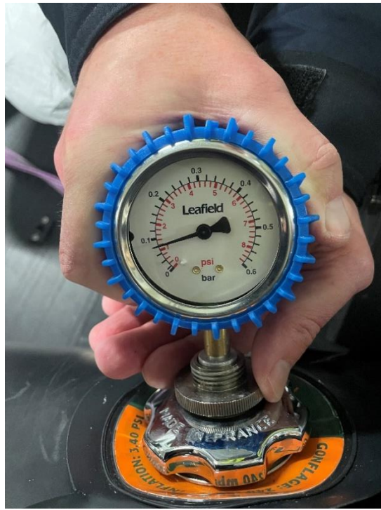
Figur 65: Manometer montert på påfyllingsventil. Foto: SHK
