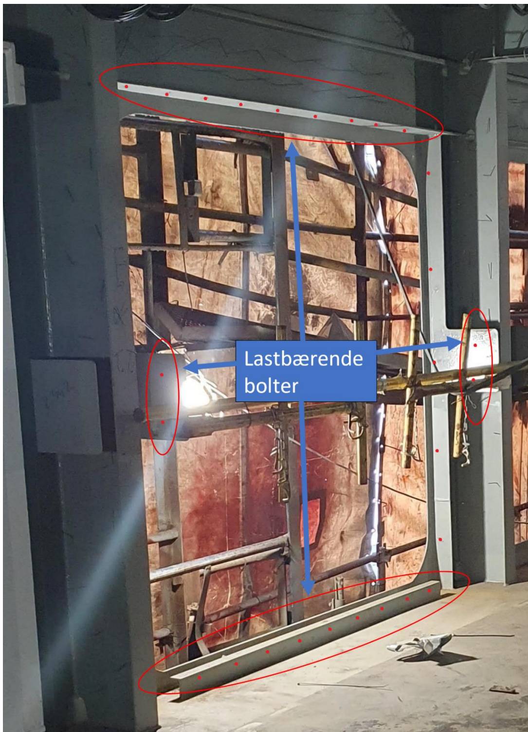
Figur 73: Boltinnfesting, røde punkter viser hvor boltene sitter. De lastbærende boltene er fremhevet. Foto: Vindusleverandør/modifisert av konsulenten
