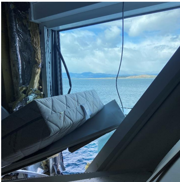
Figur 30: Skade på karm og vindu i lugar 2020. Foto: SHK
