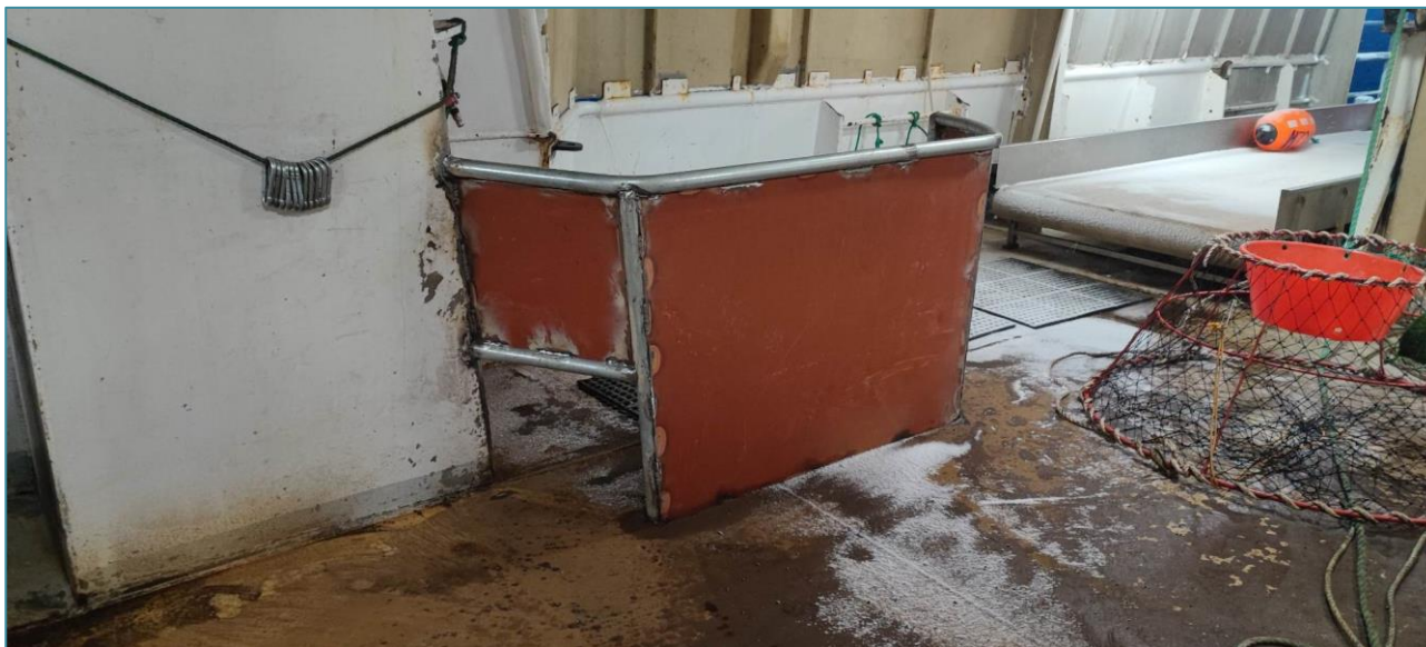
Figur 11: Stålbarriere på akterdekket for å hindre fall over bord. Foto: Rederiet
