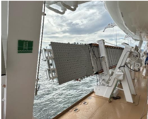
Figur 6: Daviten i en mellomposisjon mellom inne og ute posisjon. Foto: SHK
