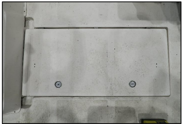
Figur 12: Flushluken i stengt posisjon. Foto: SHK
