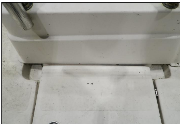
Figur 14: Dreneringskanaler som fører vannet ut gjennom sjøslagportene. Foto: SHK
