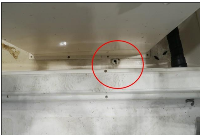
Figur 15: Dreneringshull fra dørken i styrehuset. Foto: SHK
