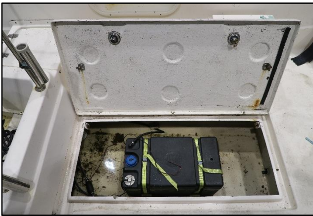
Figur 11: Flushluken i åpen posisjon. Foto: SHK
