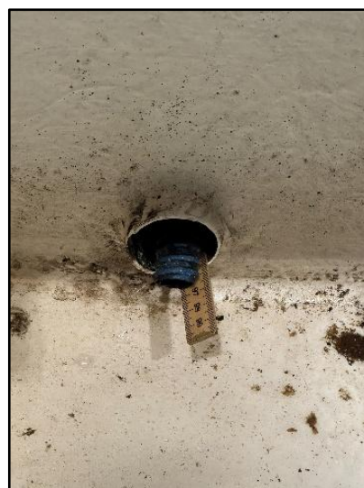
Figur 16: Gjennomføring fra dreneringen i styrehuset og inn i lasterommet. Foto: SHK
