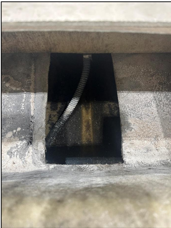
Figur 17: Dreneringsrøret gikk fra styrehuset og videre inn til lasterommet under innerliner. Vann kunne komme inn via gjennomføringen fra lasterommet, da området under innerliner var dypere enn dørken i lasterommet. Foto: SHK
