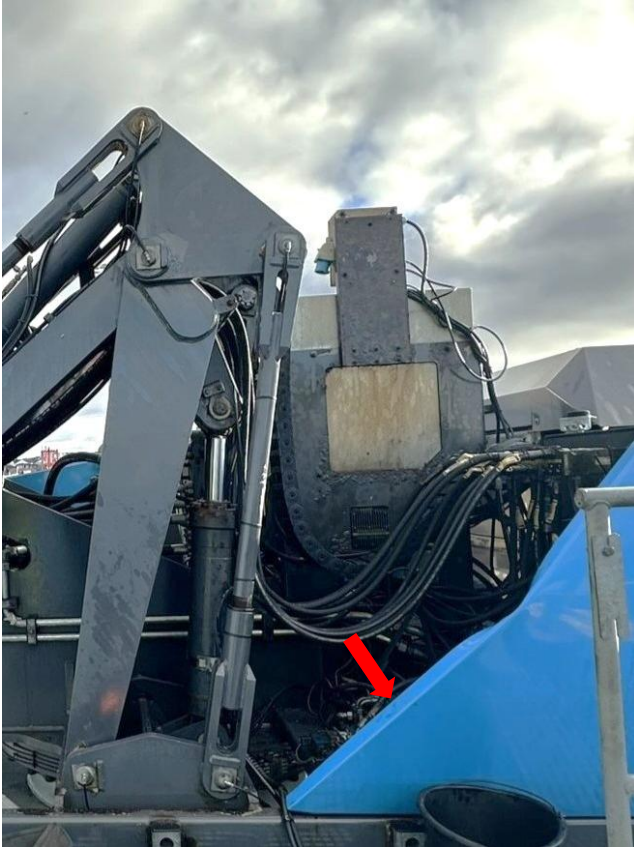
Figur 8: Rød pil viser plassering av ventilblokken bak blått beskyttelsespanel. Foto: SHK
