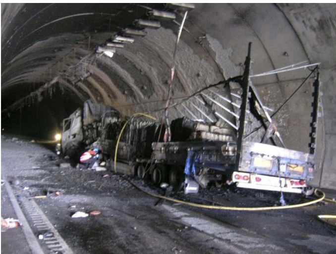
Figur 2: Kjøretøyet der det ble stående utbrent i tunnelen etter ulykken. Bildet viser også skader i tunnelhvelvet.
