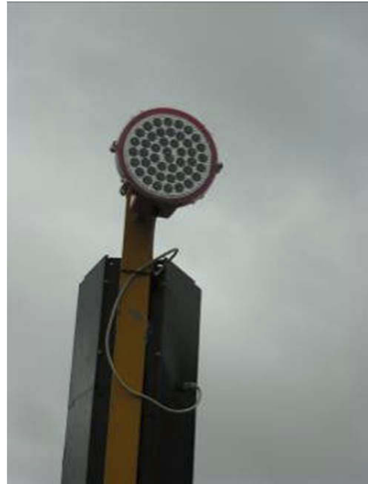
Figur 12: Rød lampe montert på baksiden av signalholdet som var koblet sammen med det røde trafikklyssignalet.
