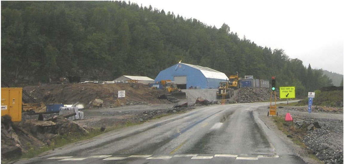
Figur 10: Krysningsstedet sett fra Lillesandsiden på Rv 402. Bildet er tatt en måned etter ulykken. Trafikklýssignalene er flyttet nærmere krysset, og det er anlagt hump i kjørebanelen etter ulykken.
