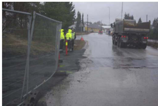
Figur 17: Innkjøringen til anleggsområdet i Bergemoveien (ved de røde sylindrene) der lastebilen rygget på en fotgjenger (foto: SVV).
