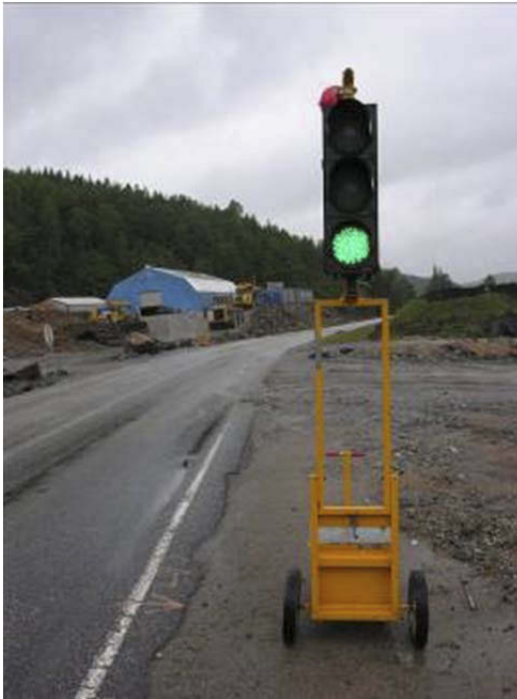
Figur 11: Mobilt lyssignal oppsatt fra Lillesandsiden. Tilsvarende oppsett fra Birkelandsiden. Lysene står her nærmere krysningsstedet enn på ulykkestidspunktet.
