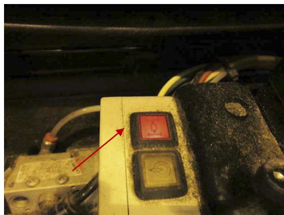
Figur 26: Viser varselampene på manøverpanel, den røde lampen slukker når låseklossene settes i låst posisjon. (Foto: Statens vegvesen).
