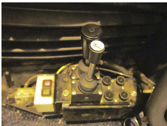
Figur 25: Viser manøverpanel ved førerplass. (Foto: Statens vegvesen).
