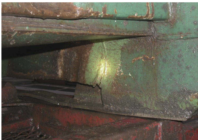
Figur 40: Container med utvidet hull og deformasjoner i rammevange (Foto: Statens Vegvesen).
