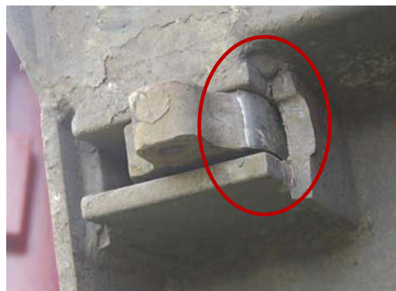
Figur 8: Monterte høyre låseanordning sett fra undersiden med manglende tapp som tar vertikalbelastning, samt slitasje i mothake for tapp.
