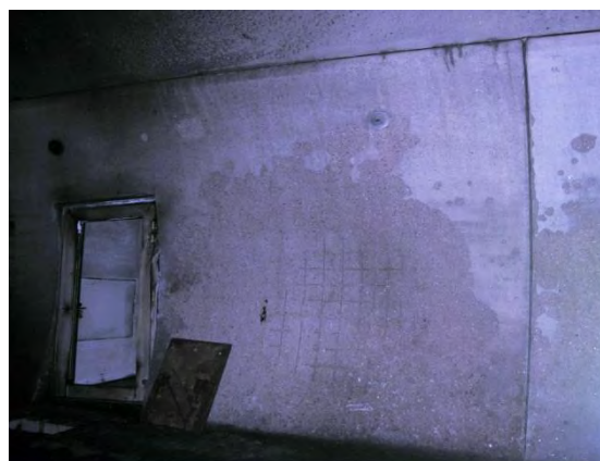
Figur 10: Brannskader på dør til SOS-stasjon. Foto: SHT
