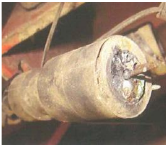
Figur 11: Korrosjon i kontakt på semitraileren. Foto: Statens vegvesen
