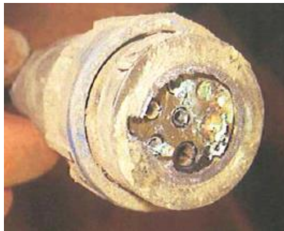
Figur 12: Korrosjon i kontakt på semitraileren. Foto: Statens vegvesen
