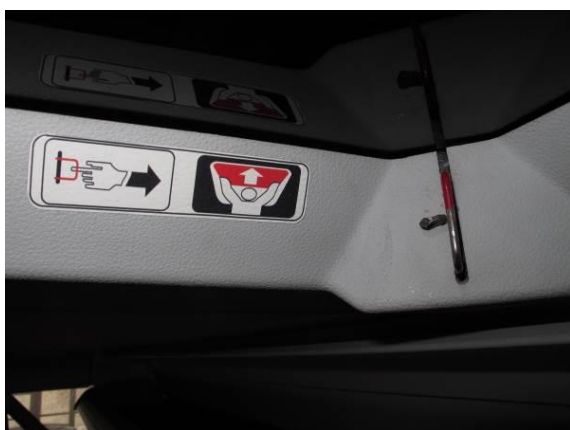
Figur 8: Merking ved takluker og handtaket til utløsermekanismen til bakre takluke. Foto: SHT
