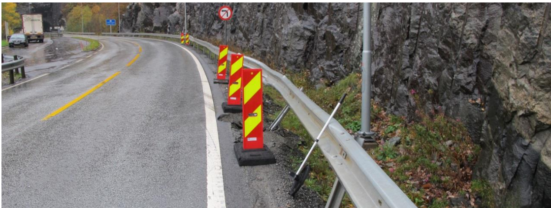
Figur 8: Skader på rekkverk sett vestover. De nærmeste hindermarkeringene er ved sluttposisjon til vestgående vogntog. Ca. 30 meter lenger vekk i bildet er merker fra østgående semitrailer. Bildet tatt dagen etter ulykken. Foto: SHT
