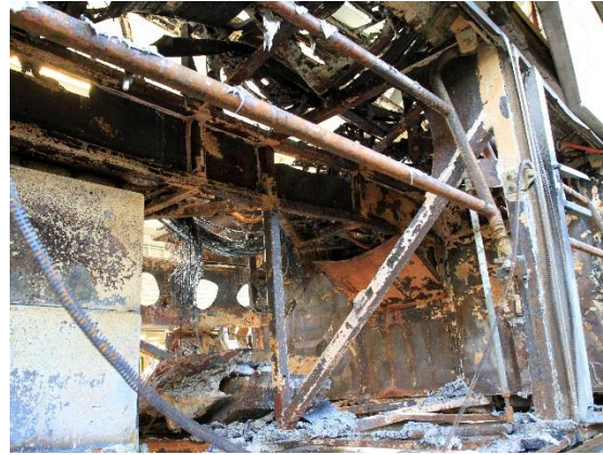
Figur 14: Lasterom med batterikasse. Foto: SHT
