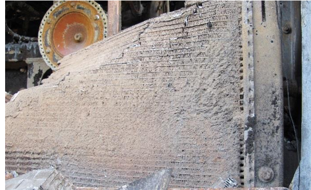
Figur 10: Radiatoren var tilsmusset. Foto: SHT
