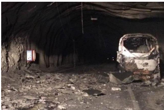
Figur 6: Nedfall, bildet er tatt i retning mot Gudvangen. Foto: Aurland brannvern
