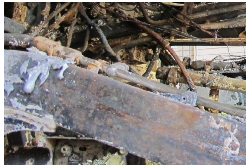
Figur 12: Dyser fra brannslokkeanlegg plassert i bakkant av motorrom. Foto: SHT
