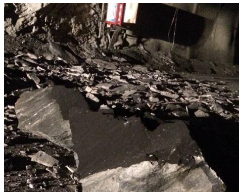
Figur 7: Nærbilde nedfall. Foto: Aurland brannvern
