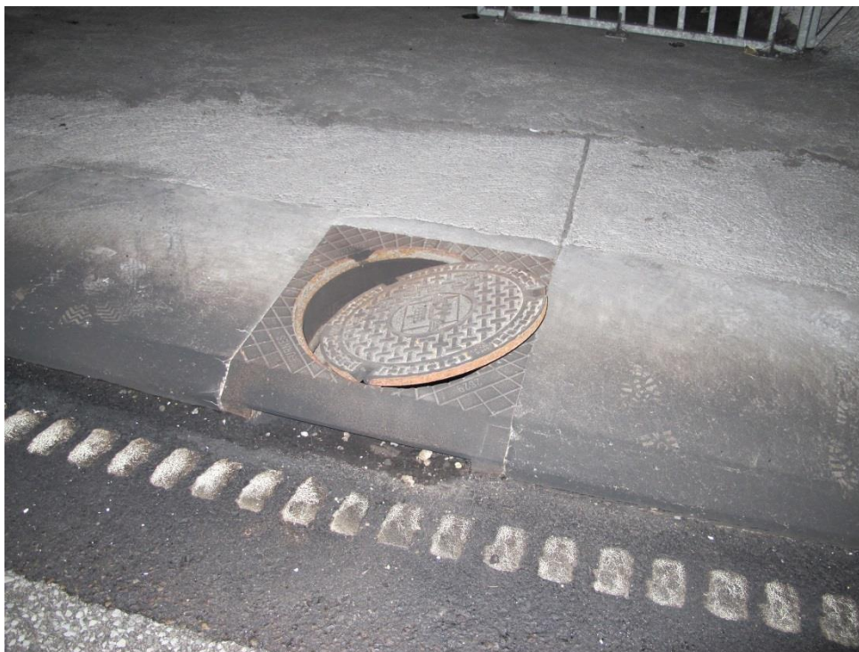
Figur 3 En dräneringsbrunn där bensin kan samlas upp genom den 60 cm breda och ca 5 cm höga öppning (”svalg”) som finns mot vägbanan. Den svarta strimma (ungefär 0.7 m bred i bilden) på vägbanan är där den största andelen bensin rann ner och som sedan tog eld (därav märken). Brunnen på bilden stod 187 m nedanför släpet.
