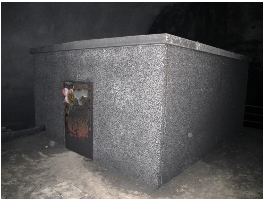
Figur 31: Pumpestasjonen ved bunnen av tunnelen med brann- og sotskader på overflatene. Foto: SHT
