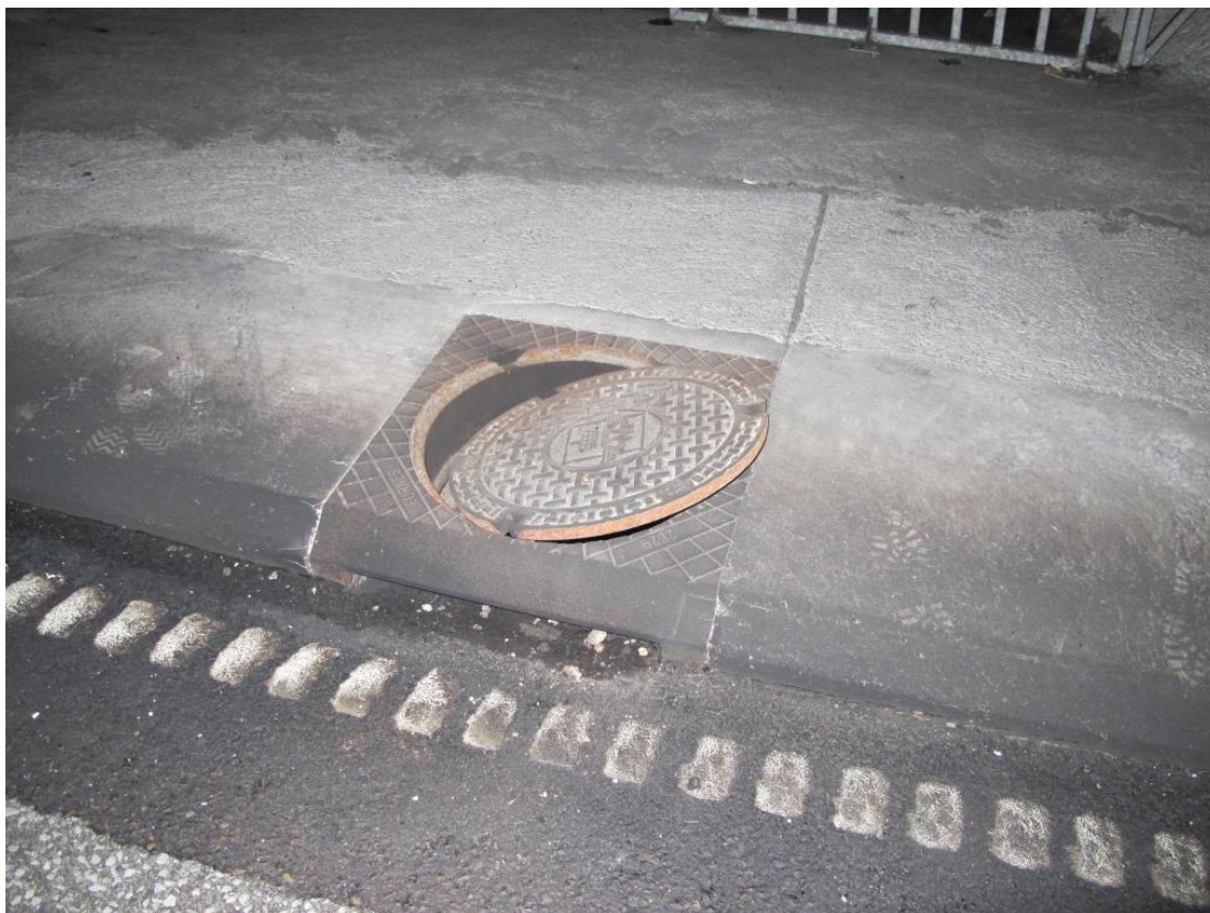
Figur 30: Sandfangkum med sluk om lag 270 meter nedenfor brannstedet. På bildet ses mørke spor av bensin som har rent forbi sluket. Foto: SHT
