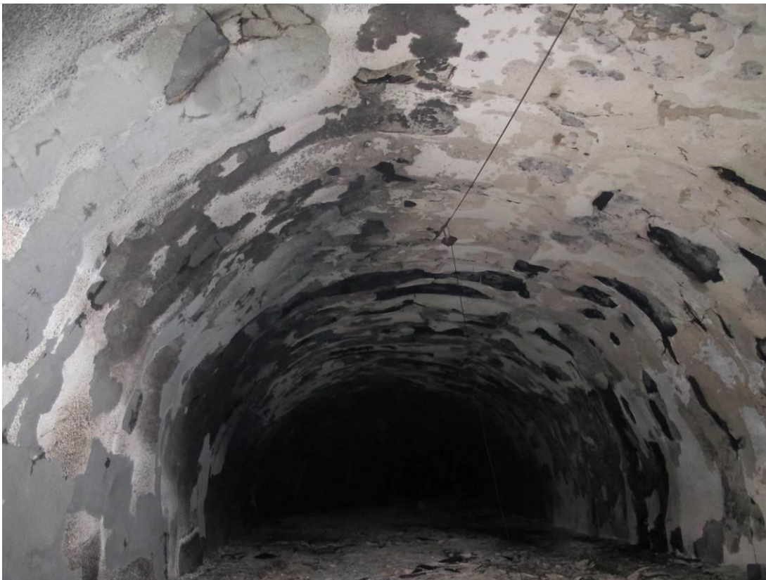
Figur 9: Viser skader på tunnellopet på det stedet tanktilhengeren sto. Bildet er tatt i den retningen røyken ble ventilert. Foto: SHT
