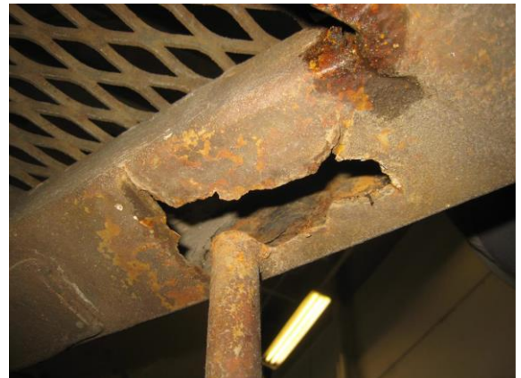
Figur 14: Rustskader i høyre dragstang. Foto: Statens vegvesen
