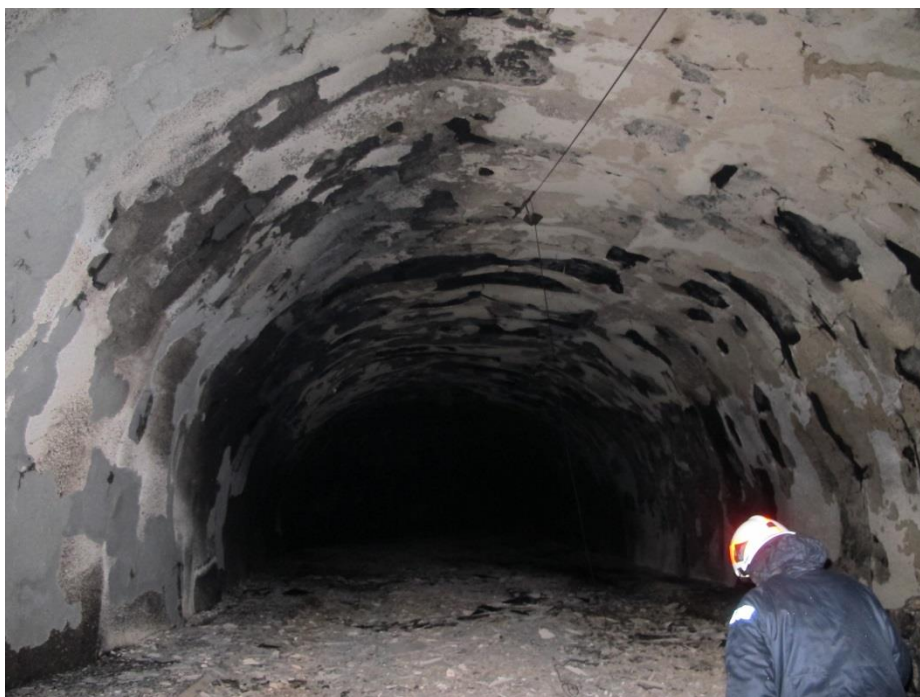
Figur 17 Skador på sprutbetongen strax ovanför släpet.
