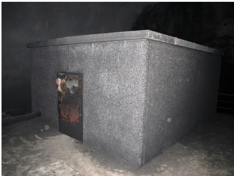
Figur 21 Väldigt speciella brandskador på dörren in till pumphuset som ligger rakt ovanför slambassängen. Bortom och bredvid pumphuset finns ett galler som man kan promenera på. Nedanför det finns slam- och vattenbassängen. Det fanns tydliga tecken på att det har brunnit nere i slambassängen.
