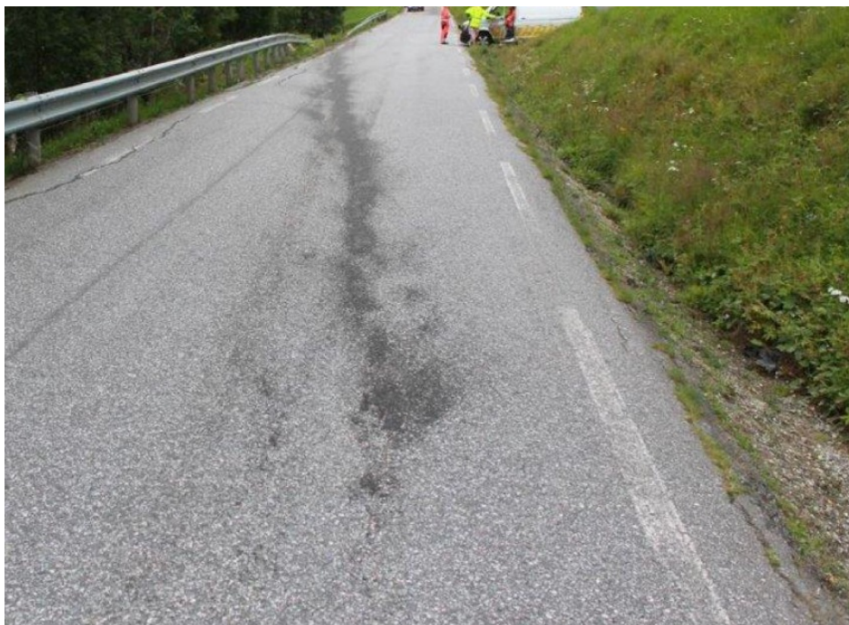
Figur 12: Veien framover fra kollisjonsstedet i bussens kjøretning, med minimal veiskulder og en sterkt skrånende grøft. Spor etter oljelekkasjen vises tydelig på bildet. Kilde: Statens vegvesen
