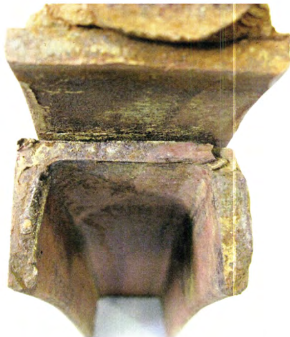
Foto 6. Det "reparerade" stödbenet. Man ser spår av det första svetsarbetet vilket troligen brustit vid tidigare användning.
