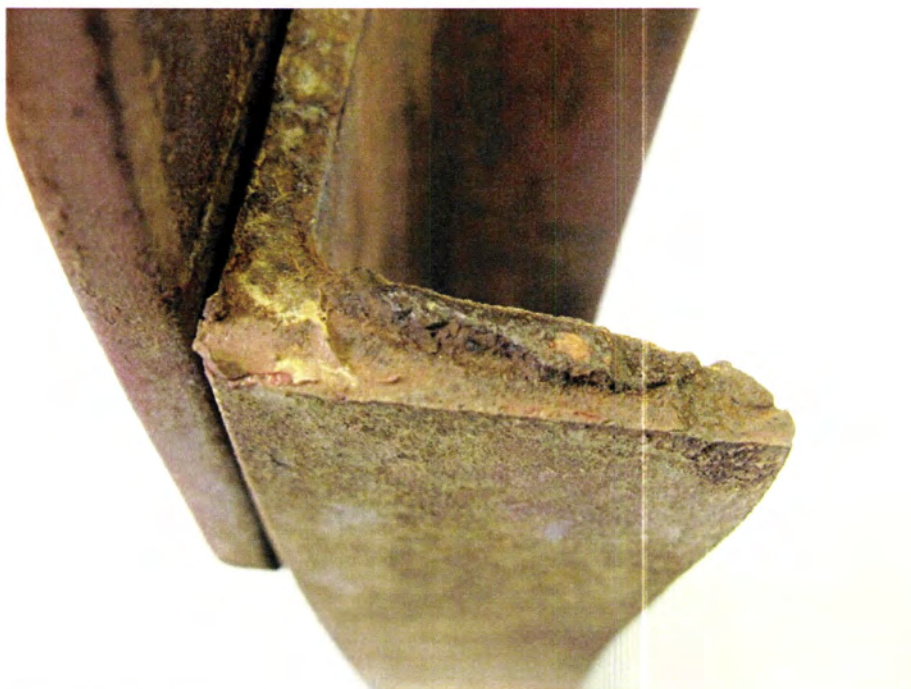
Foto 7. Detalj av det "reparerade" stödbenet.
