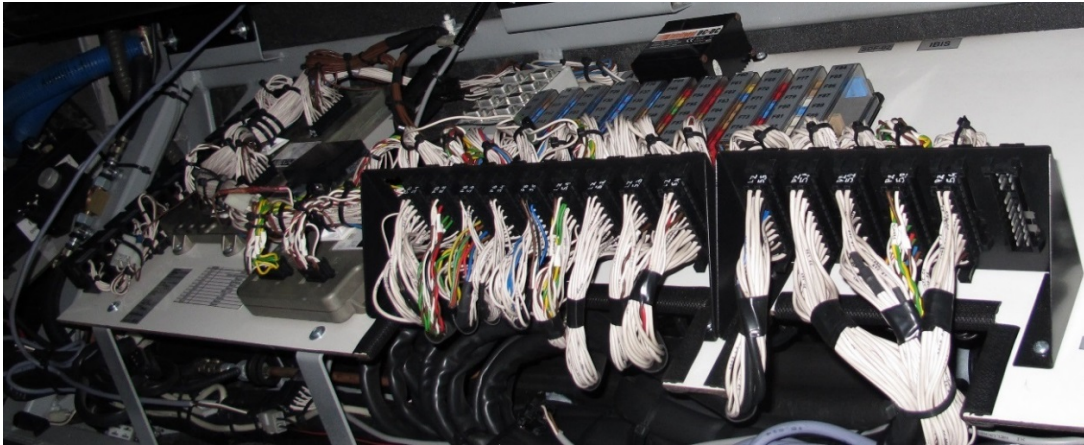
Figur 12: Sikringssskap, multipleksere og ledningsnett i de aktuelle bussene. Foto: SHT
