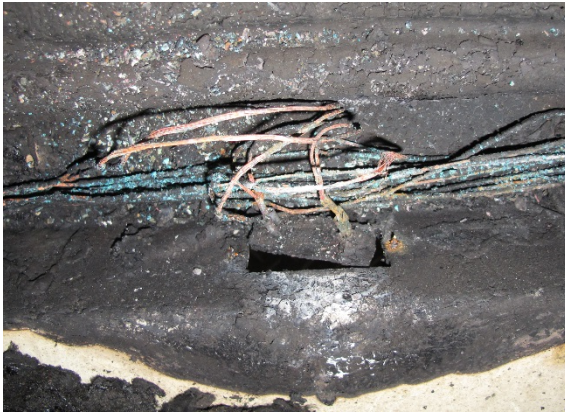
Figur 10: Skiltlys fra brann 17. desember 2016, med lysbueskader i kretsen. Foto: SHT
