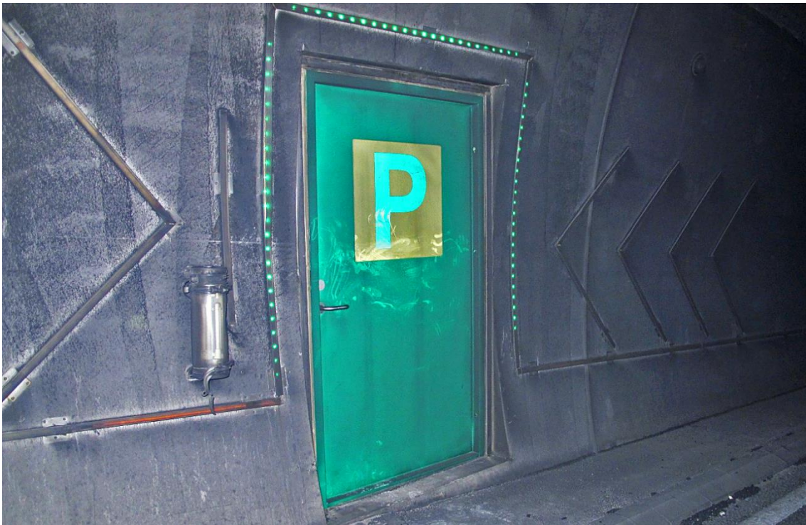
Figur 36: Dynamisk ledebelysning i grønn farge viser trafikantene veien til tilfluktsrommene. På tunnelveggene er det piler som viser vei til døren til tilfluktsrommet. Foto: SHT
