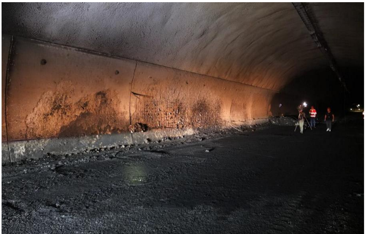
Figur 26: Avskalingskader på veggelementer i tunnelen. Foto: Aas-Jakobsen/Statens vegvesen
