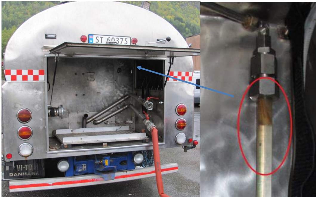
Figur 12: Fylling av vasstanken. Den raude ellipsen på biletet til høgre viser flottøren på nivåøyret i pumperommet i øvre posisjon. Foto: SHT
