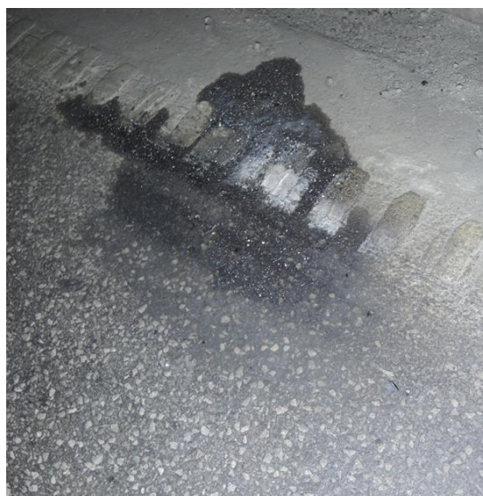
Figur 20: Vegbana der den første flammen blei observert ved 1 km, 31. mars 2019. Foto: SHK
