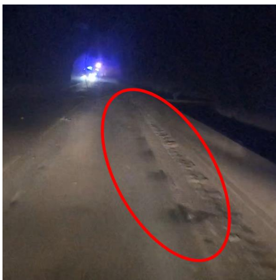
Figur 19: Vegbana rett etter brannen 30. mars 2019. Video: Aurland brannvern
