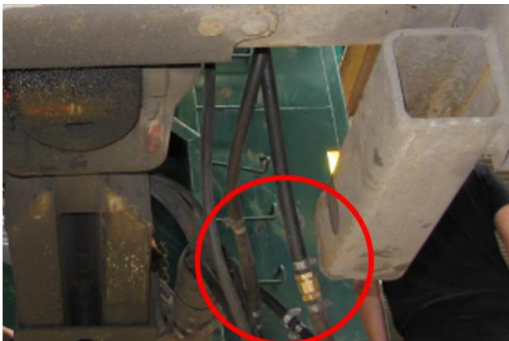
Figur 10: Innfesting av underkjøringshinder på lastebil. Rød sirkel viser slangeskjøter og bruddområde til trykkluftslanger mellom lastebil og tilhenger. Foto og illustrasjon: SHK
