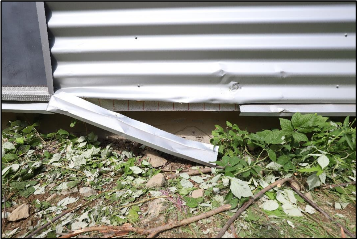
Figur 6: På veggen til næringsbygget ble en aluminiumlist revet av i kollisjonen. Foto: Politiet
