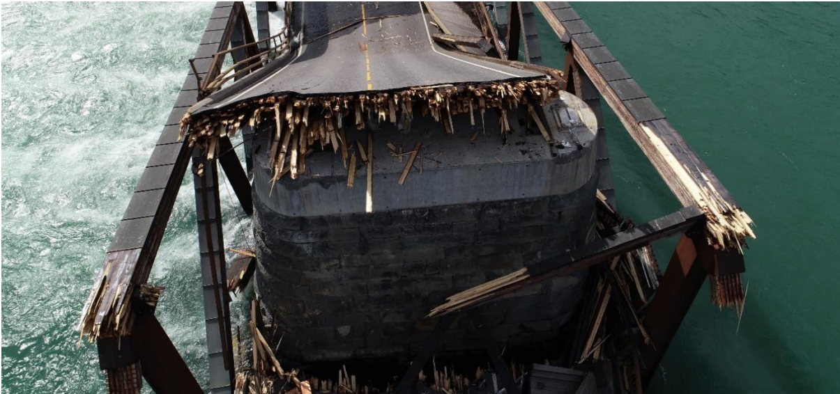
Figur 80 Tverrbæreren i akse 2 er blitt dratt av fundamentet
