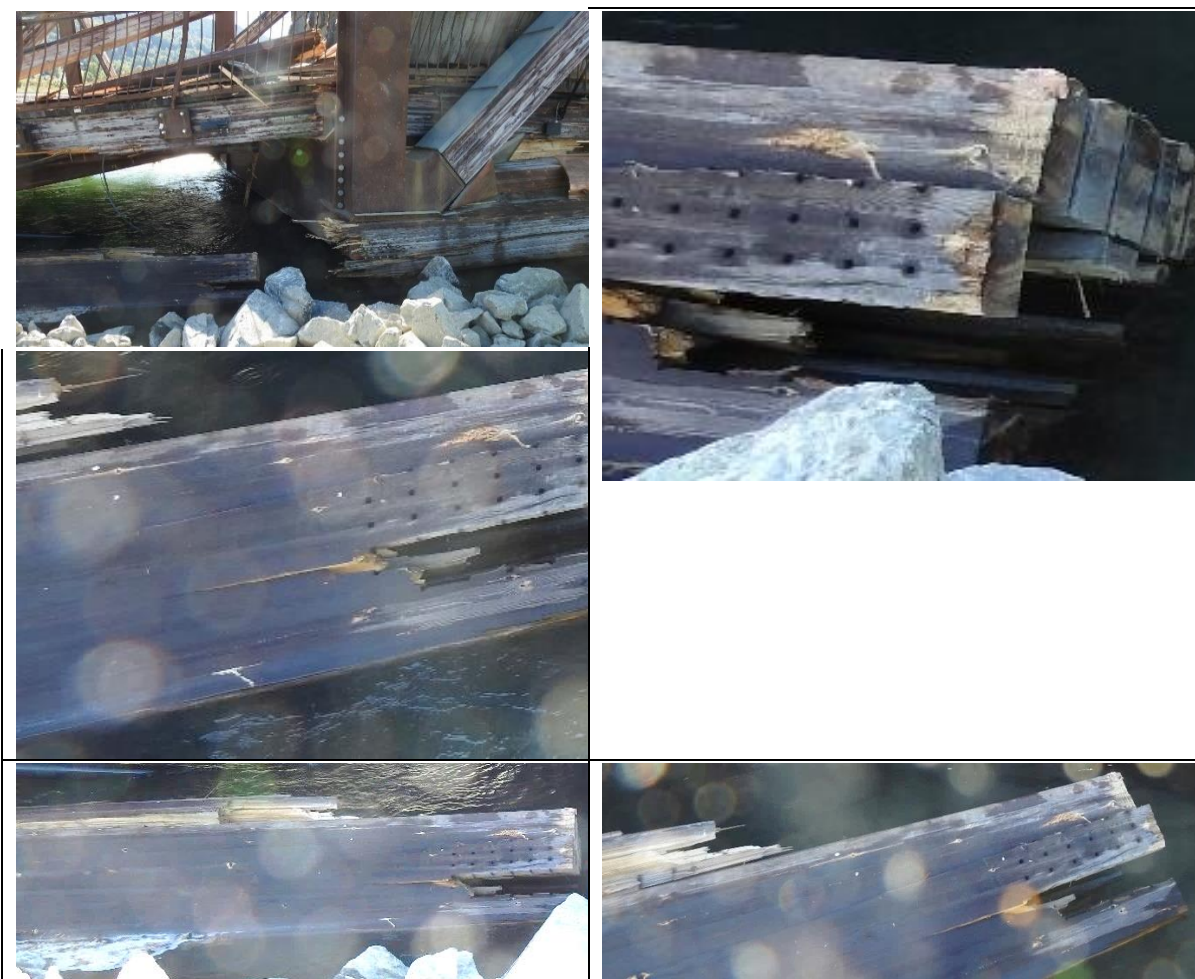
Figur 133 Innfestingen av diagonal 6A trolig mot knutepunkt UG15A
