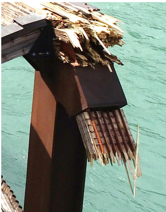
Figur 129 Knutepunkt OG14A, innfesting av diagonal 6A oppstrøms side (tatt med drone på brustedet)
