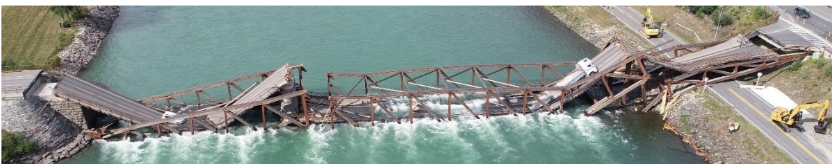
Figur 70 Tretten bru kollaps sett fra nedstrøms side.
