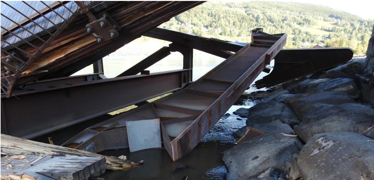
Figur 72 Tverrbjelke fra akse 1, revet løs fra fundamentet og dratt ut i elven. Styrefinnen ses på oversiden.
