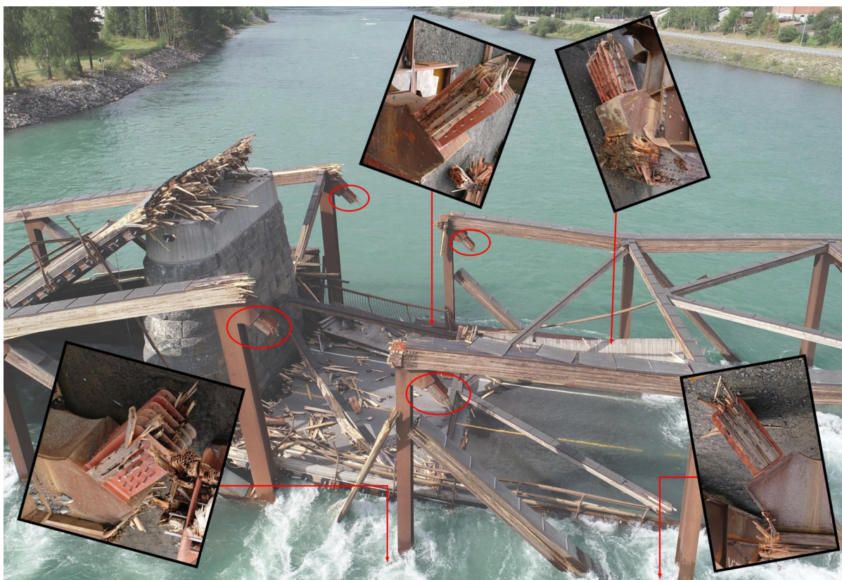
Figur 127 Bilde fra Statens havarikommisjon, informasjonsskriv 2. Brudd til høyre for akse 2
