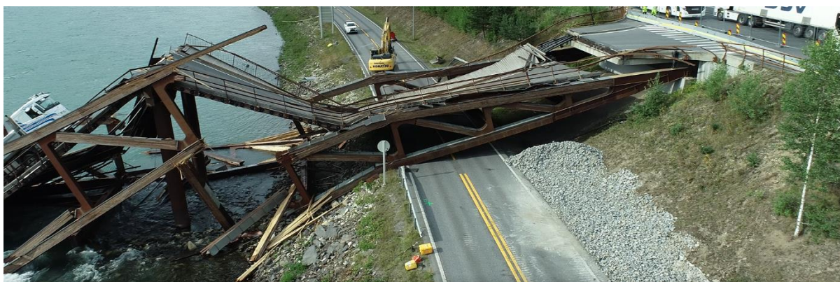
Figur 99 Brudelen ved akse 3 og 4, sett fra nedstrøms side.
