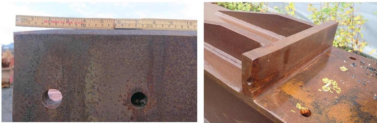
Figur 7 Til venstre: Tverrbærer i akse 3 (knutepunkt K-31 oppstrøms). Deformert sone der ståklakken på stålvertikal har "glidd av" tverrbærer. Utvidelse av boltehull pga. hullkanttrykk. Til høyre: Deformert sone på ståklakken.
