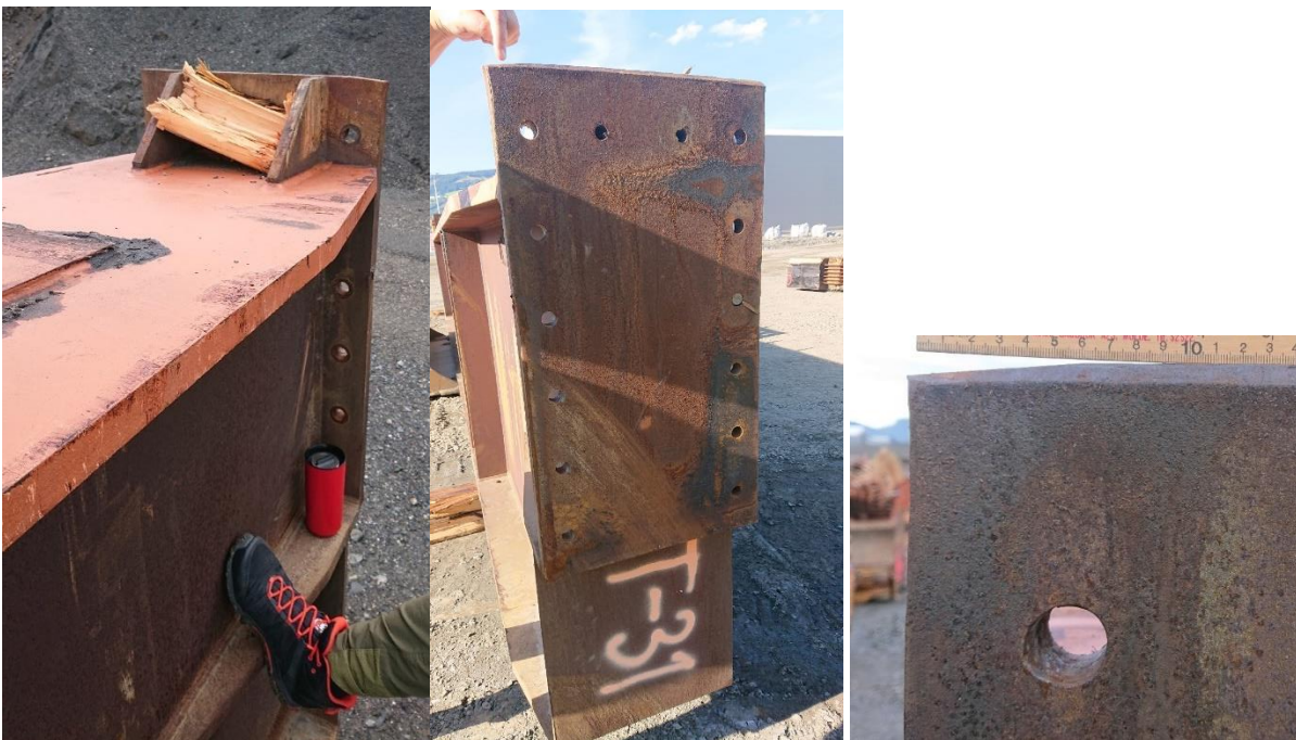
Figur 91 Stukning av endeplate til tverrbærere i akse 3, Nedstrøms side, stukning inn mot midtspenn
