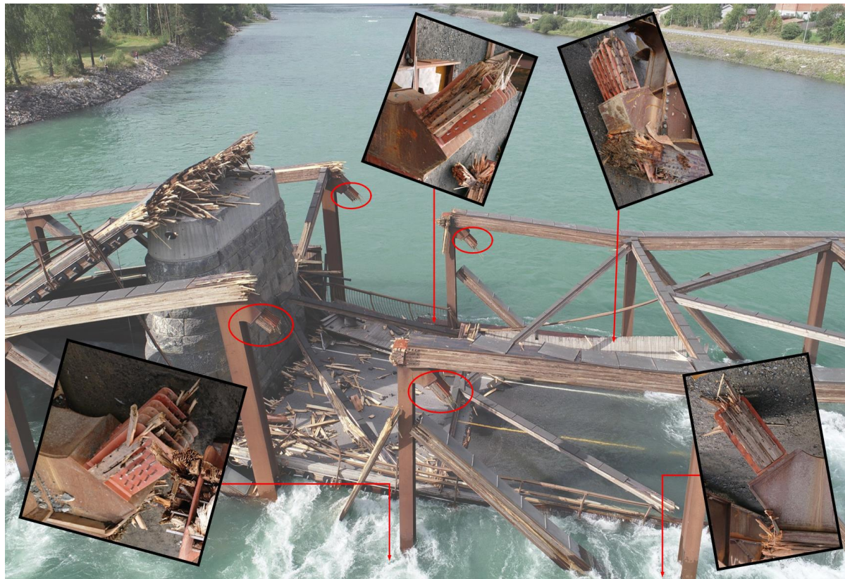
Figur 102 Bilde fra Statens havarikommisjon, informasjonsskriv 2: Blokkutrivning av diagonaler 6 og 7.
