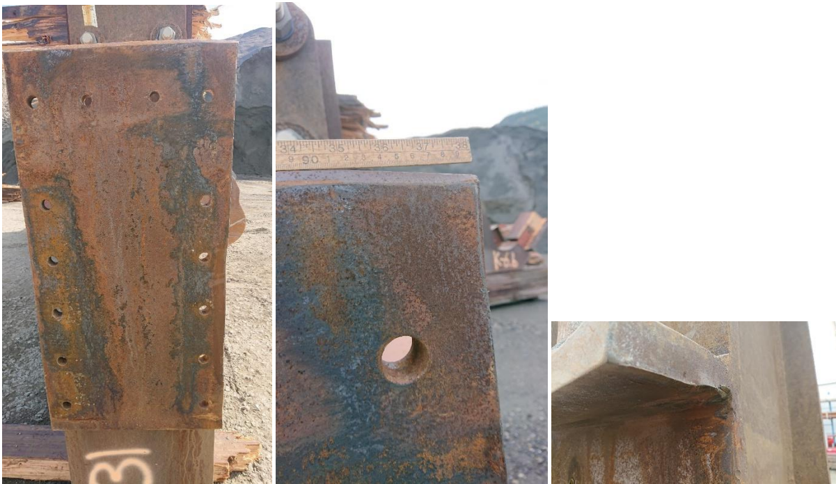
Figur 92 Stukning av endeplate til tverrbærer i akse 3 på oppstrøms side. Stukning er mot midtspennet. Klakk på stål-vertikal til høyre.
