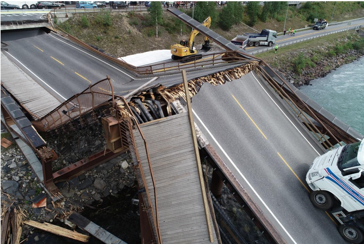
Figur 84 Akse 3 sett fra oppstrøms side, Tverrbæreren sitter fortsatt på toppen av fundamentet.
