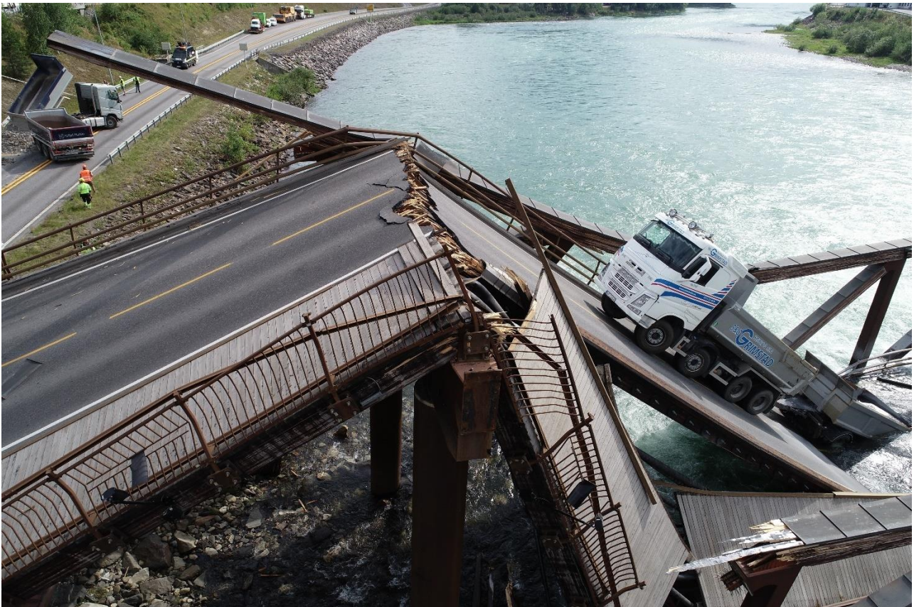
Figur 6: Lastebilens plassering på den kollapsede brua. Foto: SHK
