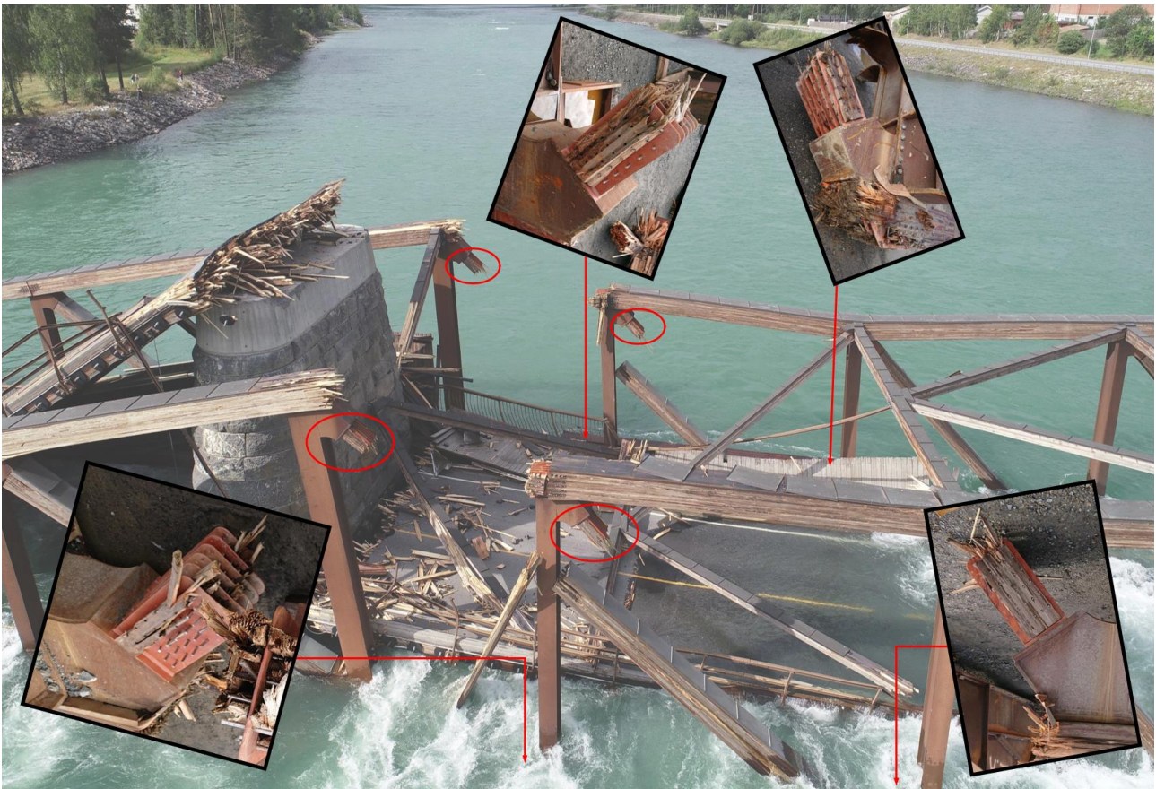
Figur 1: Røde ringer rundt øvre knutepunkt, og bilder av knutepunkt som lå under vann, tilknyttet diagonalene i hovedspennet inn mot vestre elvefundament (akse 2). Foto: Havarikommisjonen
