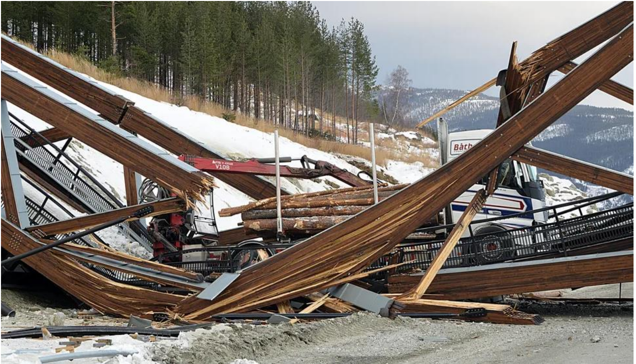
Figur 4: Kollapsen av Perkolo bru 17. februar 2016. Foto: Bård Bårdløyken, NTB Scanpix
