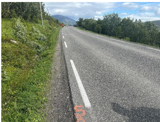
Figur 18: Veiskulder og grøft på ulykkesstedet sett i motsatt kjøreretning. Foto: SHK
