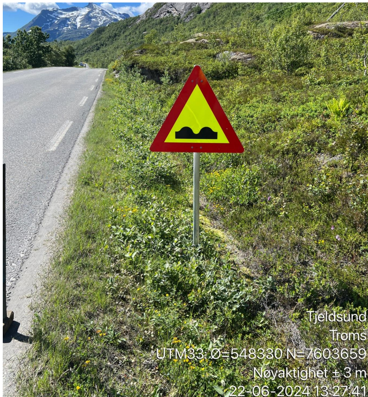
Figur 22: Midlertidig skilt 108 Ujevn veg. Foto: Statens vegvesen 22. juni 2024
