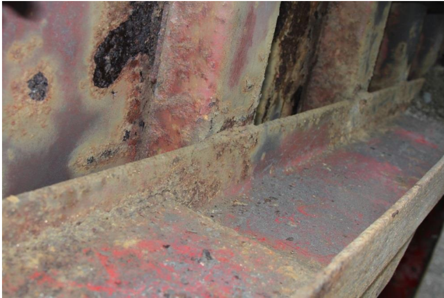
Foto 30. Sprucken svets mellom rambalk og container. Sprickan har oppstått i det område där dragbilens låsklackar greppar.
