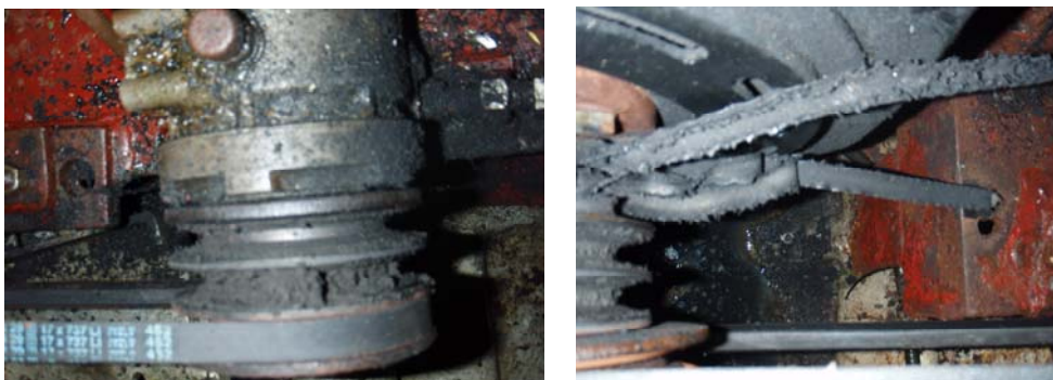
Figur 3: Foto fra maskinrommet som viser hovedmotor og hydraulikkpumpe hvor drivreim mellom enhetene er røket av.
