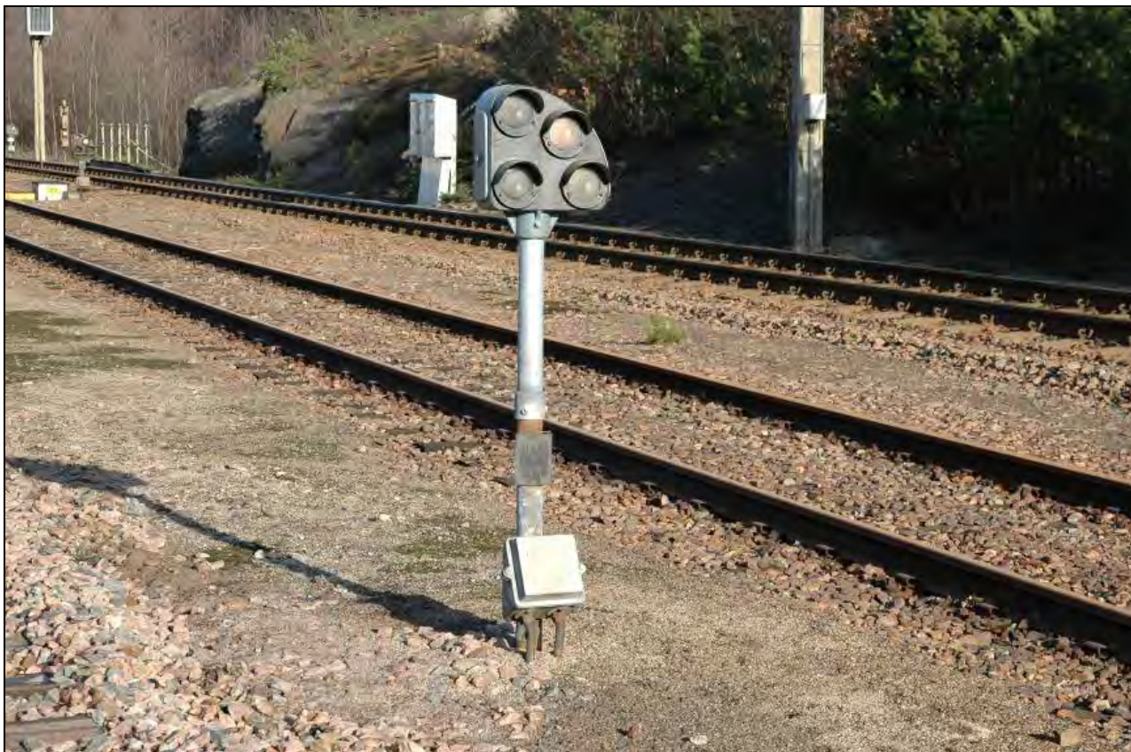
Figur 07: Dvergsignal R14. Signalmasten har etter tidligere hendelser blitt forlenget med ca ½ meter.
