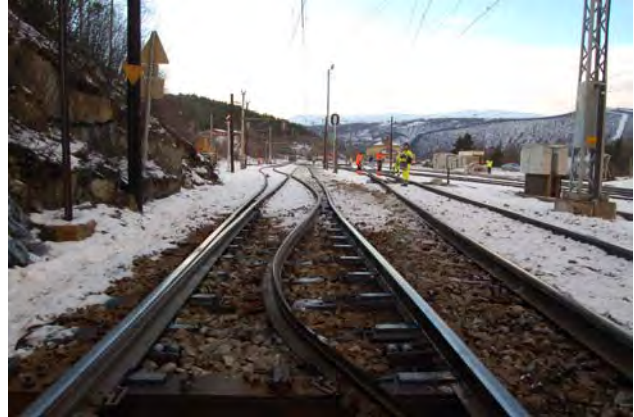
Figur 4: Skadene på skinnegang.
