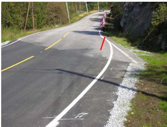
Figur 12: Overgang mellom ny og gammel vei sett i bussens kjøreretning. Rød strek markerer bremse- og skrensespor fra bussens høyre framhjul.
