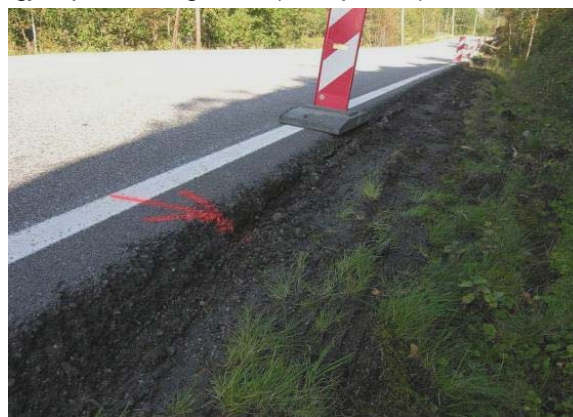
Figur 5: Asfaltkant der bussens høyre bakhjulpar kjørte ut av veibanen.
