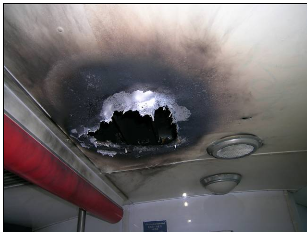
Figur 2: Bilde av brannen innvendig i taket på den ene vognen i tog 101
