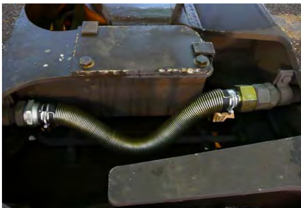
Figur 1: Bremseslange over midtboggien montert uten vridning.
