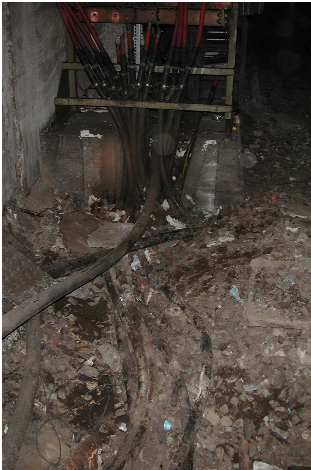
Mangelfull forlegging av kraftkablene
