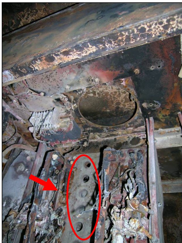
Figur 5 Arnestedet til brannen i 16.2216 ble lokalisert til omformerskapet hvor kondensatorene for hjelpestrømkretsen var plassert.
